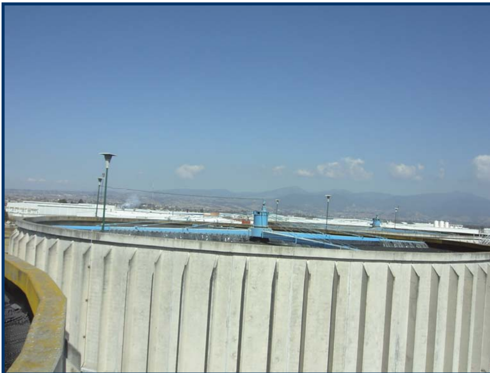
Figura No. 40. Vista del filtro percolador. Fuente del autor.
