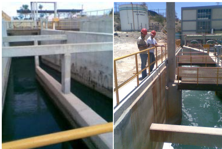
Figura 1: Obra de toma y descarga de planta termoeléctrica para enfriamiento de condensadores
