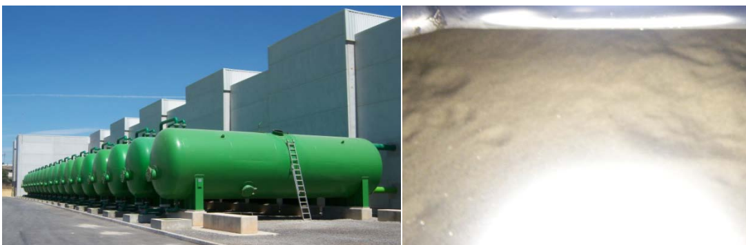
Figura 9: Filtro arena exterior (der) e interior (Izq).
