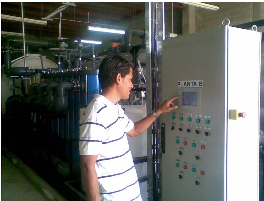
Figura 7: Sistema de arranque de planta desaladora de Veolia Waters, en Los Cabos B.C.S.
