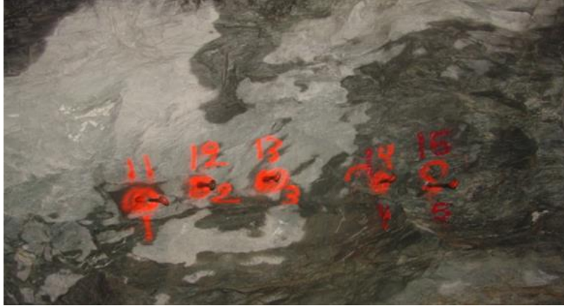
34:Figura No. VIII. 11. Anclas de prueba instaladas, con cantidad de cartuchos de cemento
