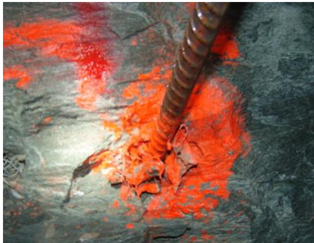
35:Figura No. VIII. 12. Instalación incorrecta de cartuchos de cemento
