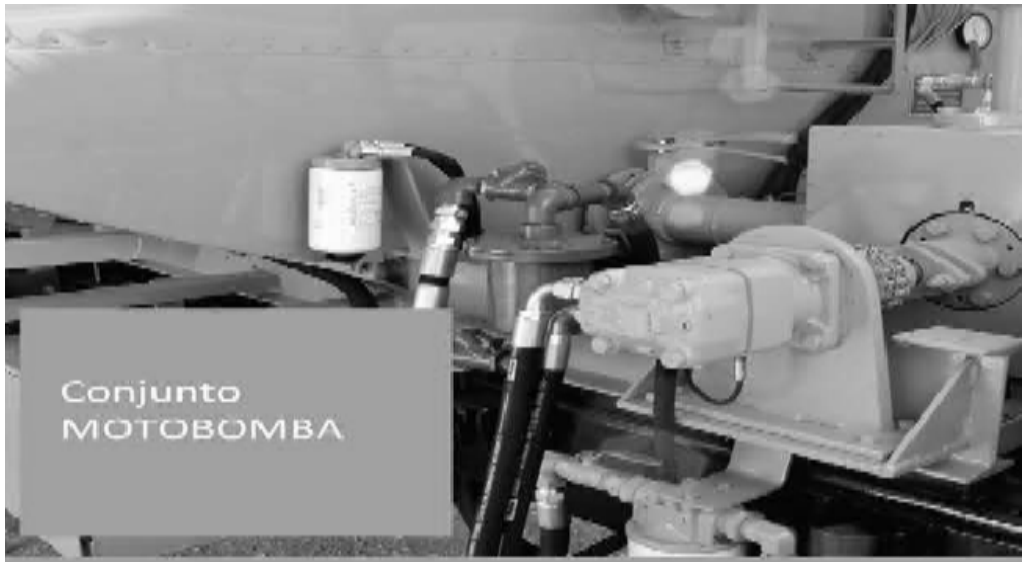
Figura 73. Motobomba sobre camión.
