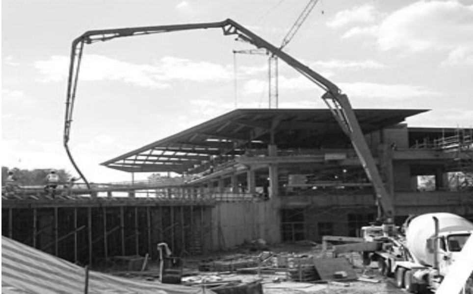
Figura 63. Equipo de bombeo móvil montado en camión, autobomba.
