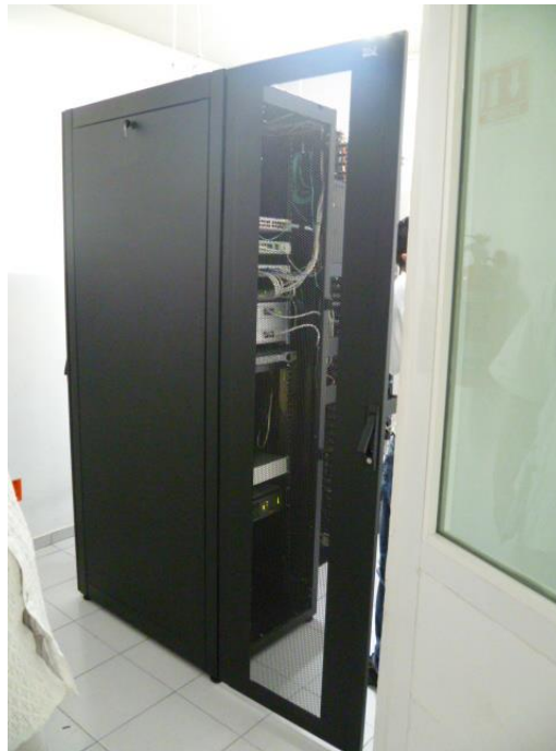
Figura 3.4 Fotografía de un MDF en Jalisco (fuente: fotografía tomada por el autor).
