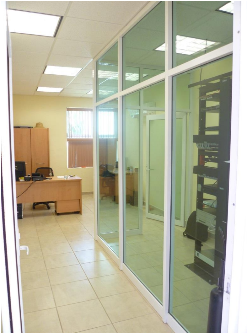
Figura 3.19 Fotografía del SITE del MDF en las oficinas de Colima (fuente: fotografía tomada por el autor).
