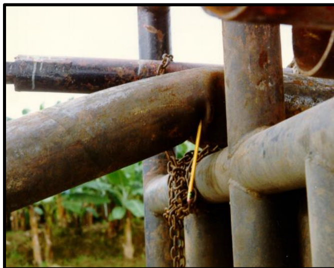
Figura 8. Falla por arrugamiento (O'Rourke y Liu 1999)
