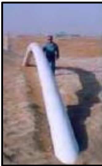
Figura 9. Pandeo de tubería (Karamanos et al. 2014)
