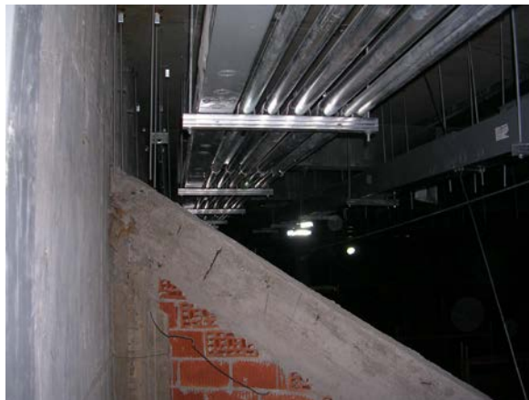
Figura 1.8 Canalizaciones en Teatro Tel Cel, CDMX.
