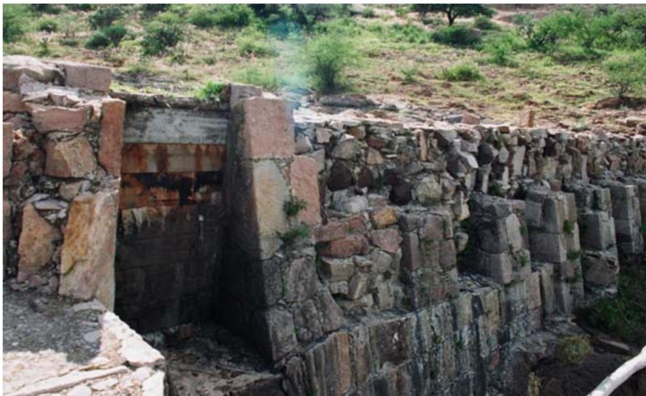
Figura 15.- Vista de los vertedores clausurados con mampostería y compuertas de madera colocadas para elevar el nivel del embalse. (Fuente: http://www.proteccioncivil.gob.mx ).
