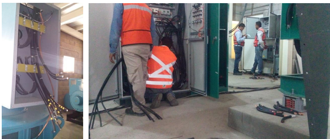
Figura 89. Personal de Aldesa en trabajos de recableado después de la oleada de robos. Foto de mi autoría.
