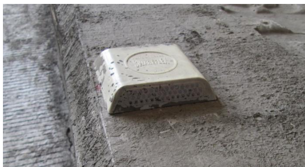
Figura 21. Vialeta blanca marca SWARFLEX con cristales reflectantes sobre banqueta de seguridad.
