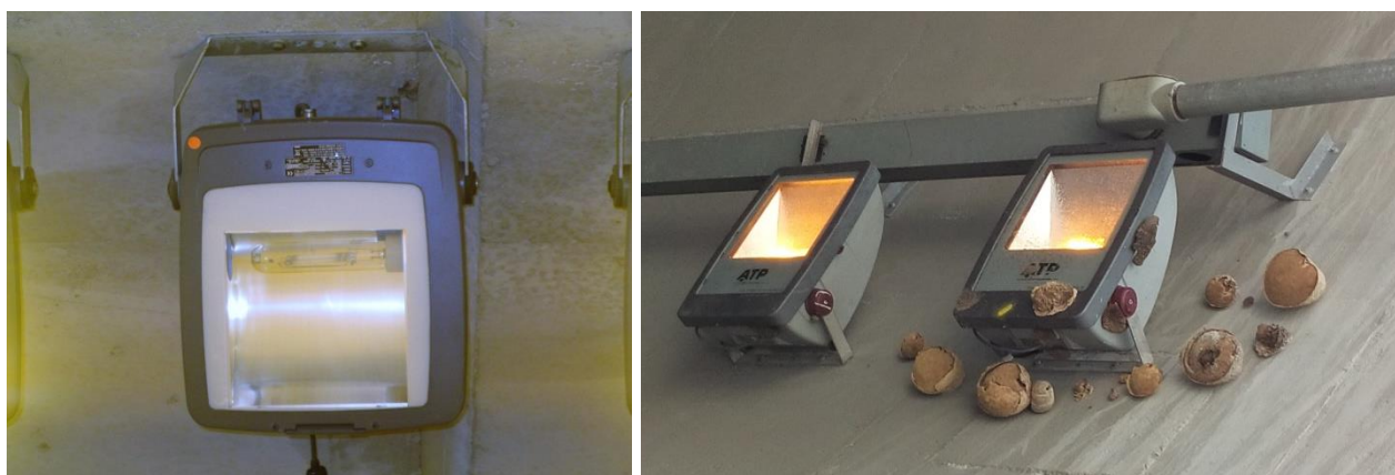
Figuras 17 y 18. Tipo de luminarias al interior de los túneles. Las hay de 100 w y de 200 w. Es frecuente la acumulación de panales de abejas en la cara de los túneles. También los quitamos. Fotos de mi autoría.
