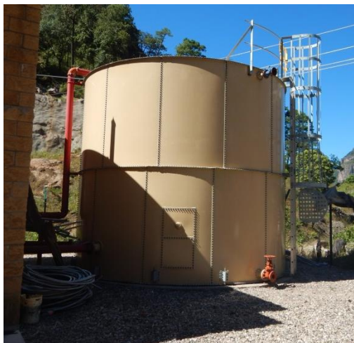
Figura 54. Tanque de emergencia contra incendios del túnel Papayito III. Foto de mi autoría.
