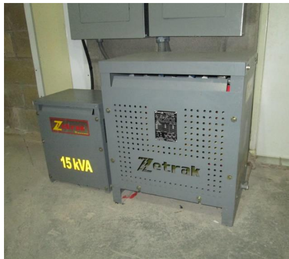
Figura 27. Transformadores de 15 kVA y 75 kVA respectivamente ubicados en la casa de máquinas del túnel Piedra Colorada
