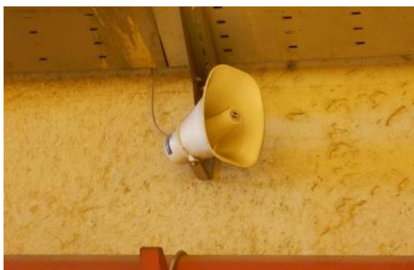
Figura 59. Altavoz al interior del túnel el Sinaloense.
