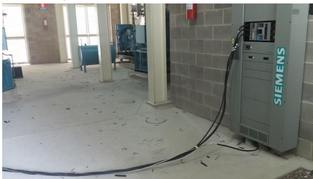
Figura 88. Cuarto de máquinas Leoneras un par de días después de ser robada, en el piso se pueden notar los "cinchos" que tenía el cable que fue robado. Foto de mi autoría.
