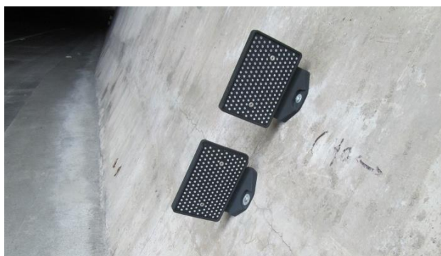
Figura 23. Vialeta negra marca SWARFLEX con cristales reflectantes en una sola cara. Colocadas sobre la pared del túnel
