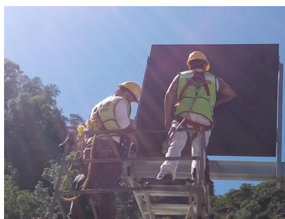
Figura 36. Señales de alto variable Exterior Limpieza mensual y revisión de cableado de estos señalamientos al exterior del túnel Papayito III. Foto de mi autoría
