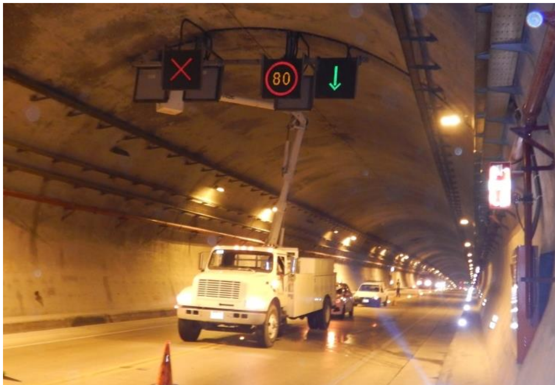
Figura 34. Señal Aspa-Flecha, Panel de límite de velocidad: Limpieza mensual y revisión de cableado de estos señalamientos en el túnel El Sinaloense. Foto de mi autoría
