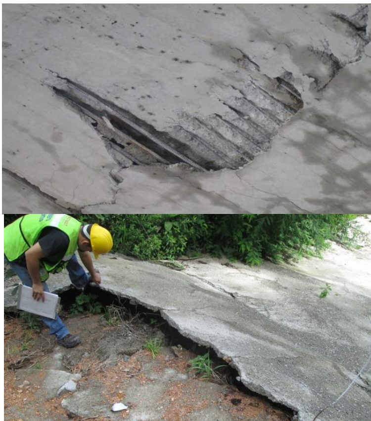
Figuras 72 y 73. Deslave de talud muy importante sobre el falso túnel Panuco, causo agrietamientos y daños estructurales de gran importancia en la estructura; además de mantener la carretera cerrada en un tramo por varios días. La inversión económica para dar solución será enorme. Fotos de mi autoría.
