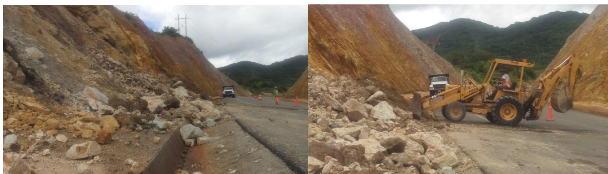
Figuras 62 y 63. Derrumbe cotidiano hacia la parte baja de la sierra de Sinaloa. Talud de materia rocosa muy fracturada. Algunos bloques rebasan el medio metro de diámetro. Fotos de mi autoría.
