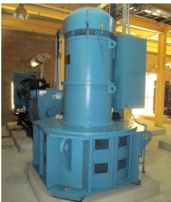
Figura 13. Unidad de Continuidad (Volante de inercia)
