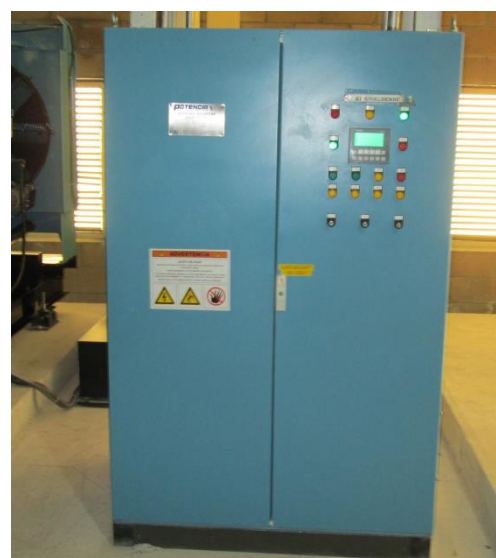
Figura 14. Tablero de control de sistema ASTRONIC dentro de la casa de máquinas del túnel El Sinaloense. Foto de mi autoría
