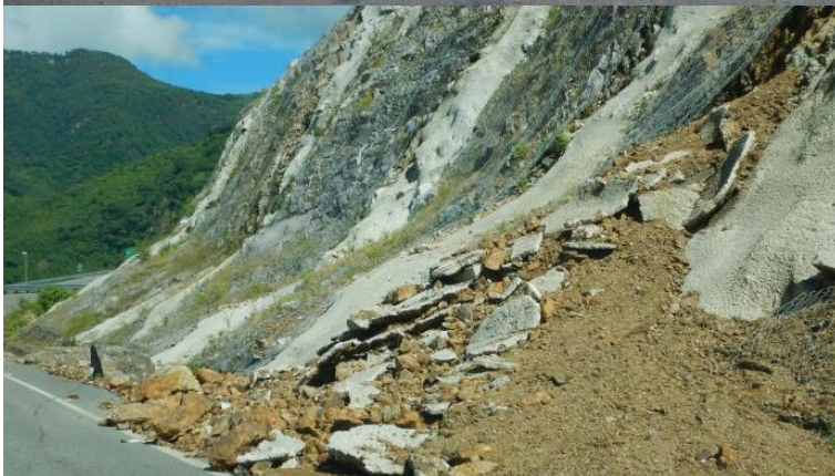
Figuras 66 y 67. Otro de los tropiezos que se cometen es tratar de remediar los taludes con métodos poco efectivos que francamente resultan contradictorios. A este talud por ejemplo, se le puso maya de triple torsión anclada con bulones e intercalada con muro gunitado. El talud sigue fallando a pesar de la inversión poco efectiva. Fotos de mi autoría.
