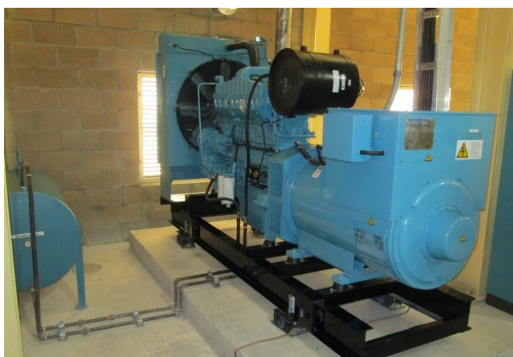
Figura 12. Motor y tanque de diesel en la casa de máquinas del túnel El Sinaloense. Foto de mi autoría
