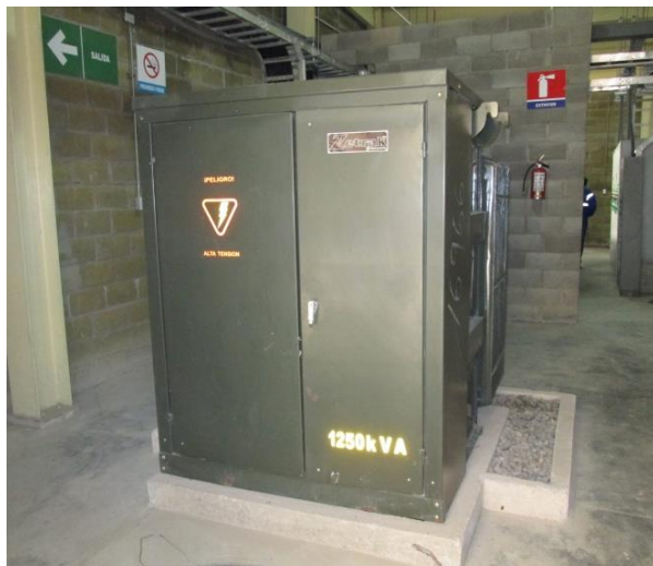
Figura 26. Transformador Zetrak de 1250 kVA ubicado en la casa de máquinas del túnel Piedra Colorada
