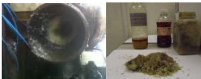
Fig. 1 Incrustaciones salinas en tuberías del campo A
