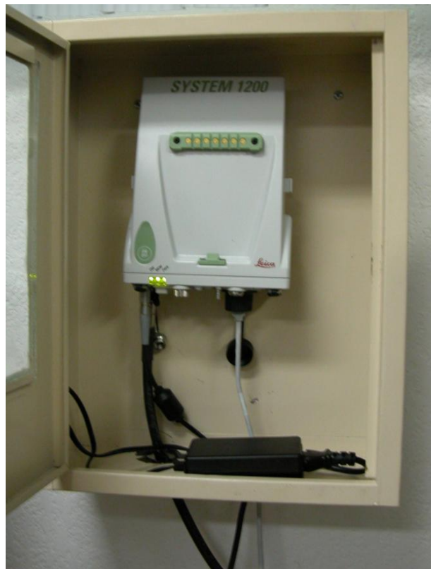
Fig. IV-11. El Receptor GPS de la Estación GRPY resguardado en una caseta de seguridad y al interior del edificio del Organismo de Cuenca en Mérida, Yucatán.
