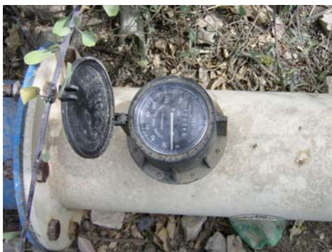
Figura III-8. Medidor de pozo. Comisión Nacional del Agua.
