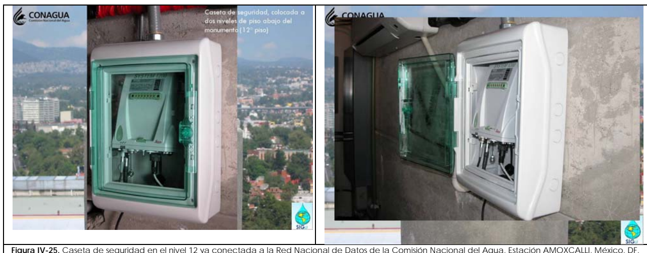
Figura IV-25. Caseta de seguridad en el nivel 12 ya conectada a la Red Nacional de Datos de la Comisión Nacional del Agua. Estación AMOXCALLI, México, DF.
