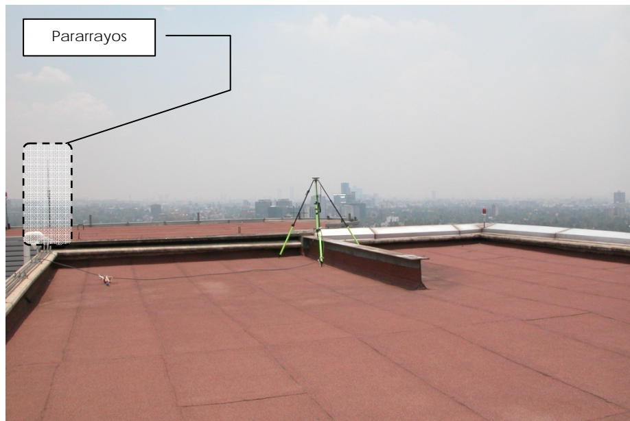
Figura IV-4. Pararrayos en edificio de la Comisión Nacional del Agua. México, Distrito Federal
