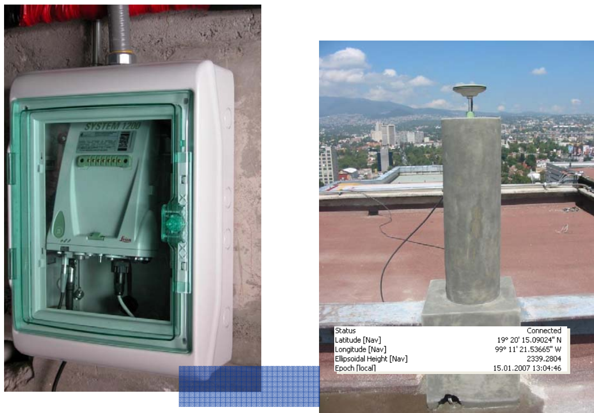
Figura III-25. Estación de Referencia GPS instalada en la Comisión Nacional del Agua. Distrito Federal, México.
