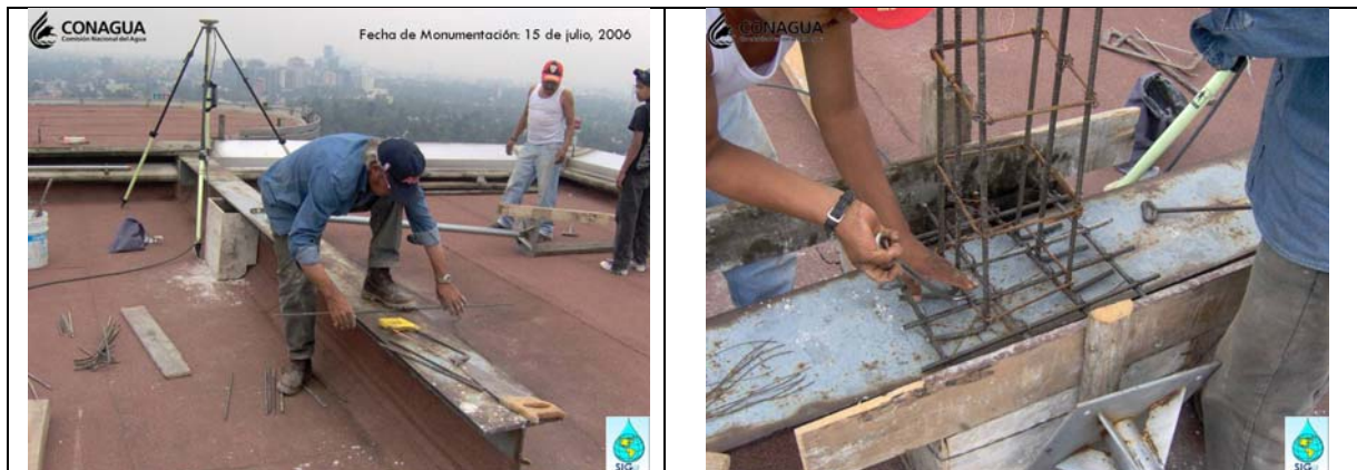
Figura IV-22. Armado de la estructura para soporte de la base monumentada. Varilla de 1/2". Estación AMOXCALLI, México, DF.
