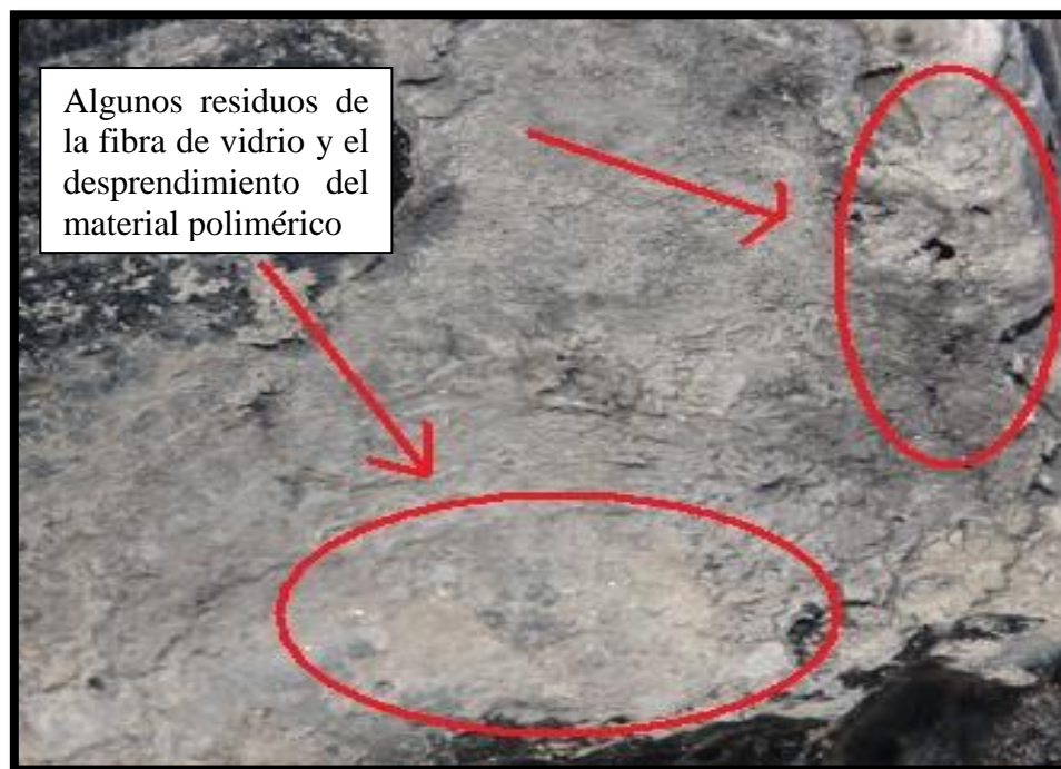
Figura 3.18 En esta imagen se observa pérdida de textura.
