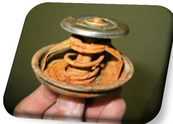
Figura 3.9 Efectos de la corrosión al adherirse partículas en la válvula termostática, lo cual propicia una inadecuada apertura.
