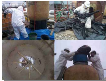
Figura IV.2.7 Detalle del equipo de carbón activado.
