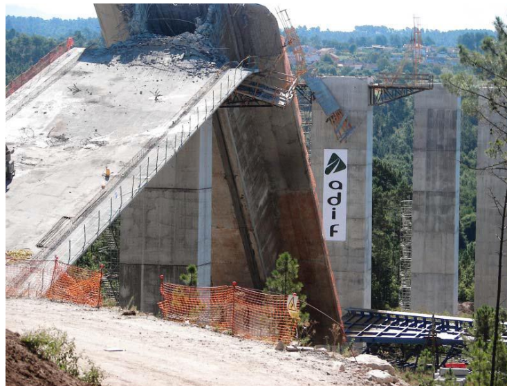
Figura 2.13. Deslizamiento de la superestructura
