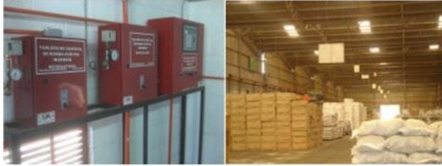
Figura. 7 Fotos de almacén y panel de control [16].
