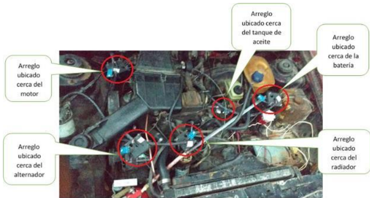
Figura 55. Sistema completo integrado al cofre del automóvil, cada arreglo está formado por un sensor de temperatura, fuego y humo.
