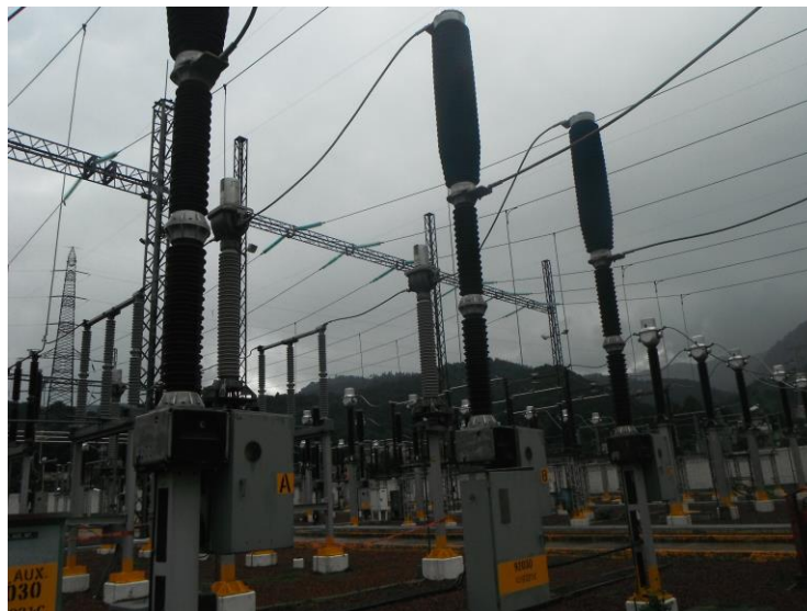
Figura 2.6 Interruptor de 230kV marca SIEMENS modelo 3APG
