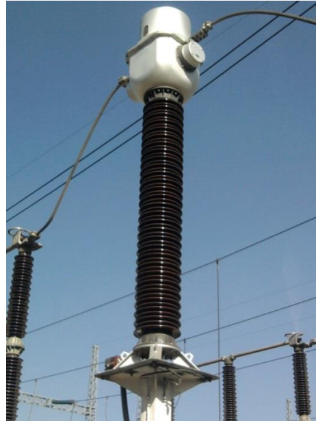
Figura 2.2 Transformador de corriente marca Artech para 230kV
