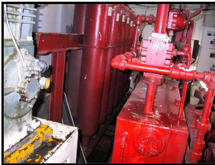
Figura 3.17 Banco de acumuladores
