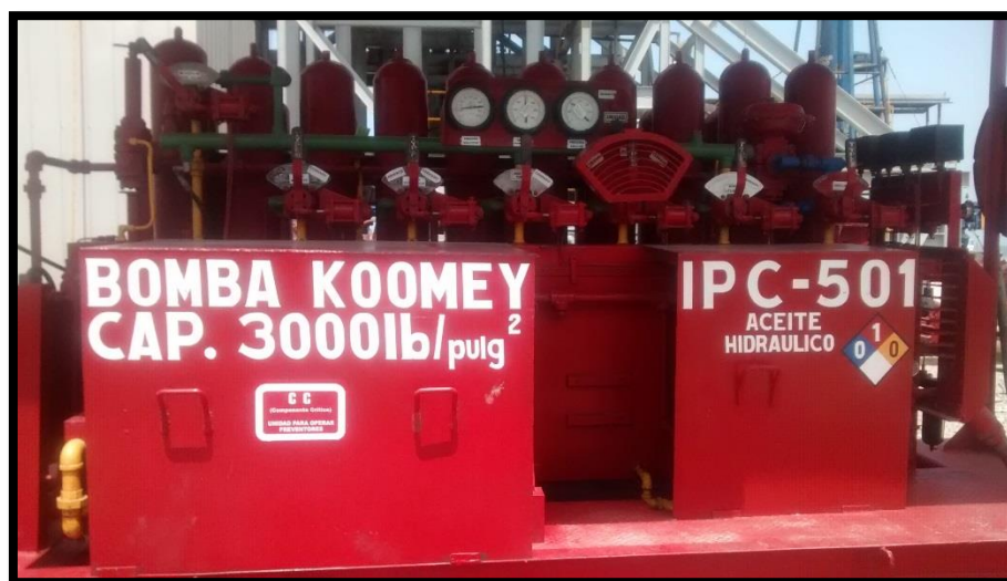
Figura 3.16 Unidad para operar preventores.
