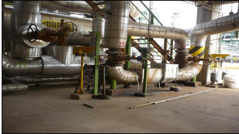
Figura 4.12. Ejemplo de líneas de tubería con asilamiento.
