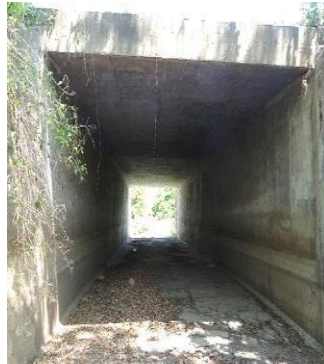
Fig. 5-3 Paso subvial tipo alcantarilla presente en el proyecto
