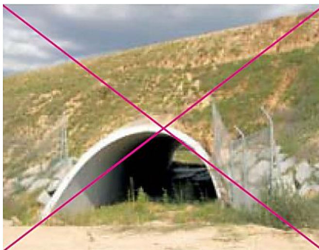
Fig. 4-36 Incorrecta instalación de vallado: no se ha completado el cerramiento encima del paso, permitiendo el acceso de animales a los taludes. Foto: C. Rosell
