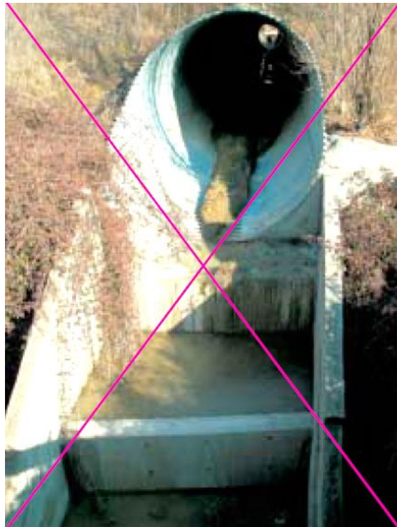
Fig. 4-55 Ejemplo 3 de malas prácticas: Bajante escalonado que constituye una trampa para la fauna. Foto: F. Navàs.
