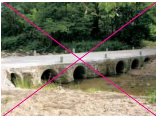
Fig. 4-62 Ejemplo 4 de malas prácticas: Drenajes situados en un badén que dificultan el paso de peces. Foto: F. Navàs.
