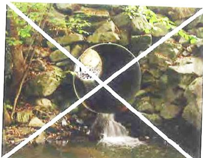
Fig. 4-60 Ejemplo 3 de malas prácticas: Este drenaje en Noruega tiene dos problemas simultáneos: Su salida tiene un nivel demasiado alto en relación al curso fluvial, dicho desnivel supone una barrera para los peces que se dirigen aguas arriba. El segundo problema es la baja altura de la lámina de agua, lo cual sugiere una trampa mortal para los peces que se dirigen aguas abajo. Foto: B. Iuell
