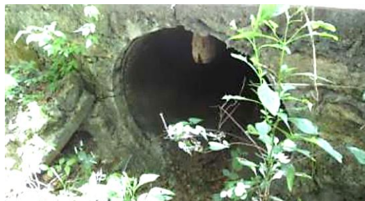
Fig. 5-11 Ejemplo de obra de drenaje ubicada en el km 161+082.3 que posiblemente sea usada por fauna de talla inferior. Foto: Ref. 16
