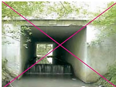
Fig. 4-61 Ejemplo 5 de malas prácticas: Escalón en el interior del drenaje que supone un obstáculo para el movimiento de fauna acuática. Foto: J. Dufek.
