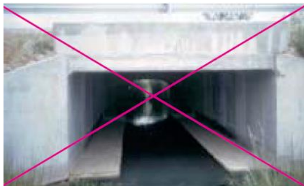
Fig. 4-53 Ejemplo 1 de malas prácticas: Falta de rampas que conecten las franjas secas con las zonas adyacentes. Foto: F. Navàs.
