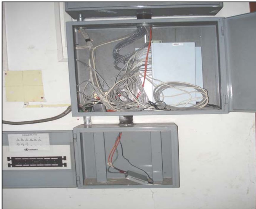
FOTO 4.22 ESTRUCTURA DE CABLEADO PARA LA SECRETARIA ESCOLAR.
