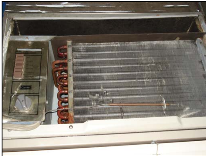
FOTO 4.6 AIRE ACONDICIONADO DEL ÁREA DE RED
