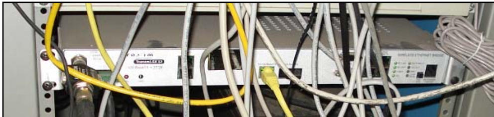
FOTO 4.25 PUENTE DE RED CON CONEXIÓN DE FIBRA OPTICA
