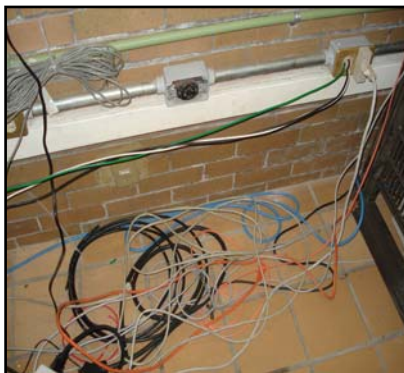
FOTO 4.7 CABLEADO DE RED
