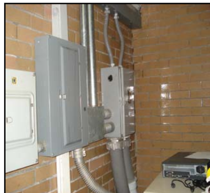
FOTO 4.8 CENTRO DE CARGA GENERAL
