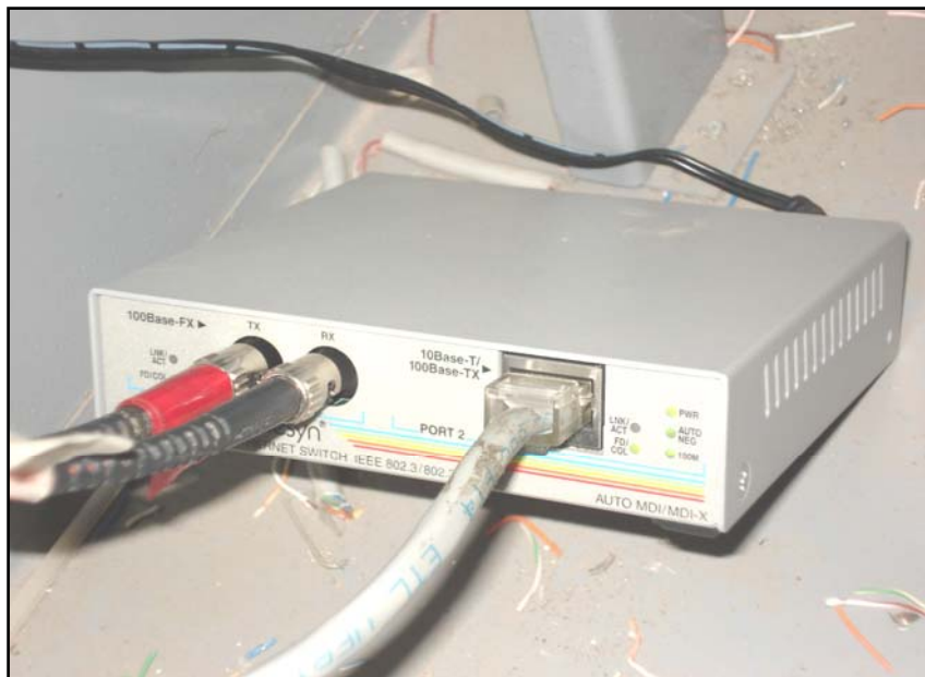
FOTO 4.24 TRANSFORMADOR DE MEDIOS PARA SECRETARÍA ESCOLAR
