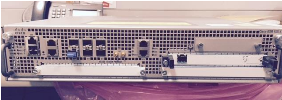
Figura 4-3. Equipos CISCO ASR 1002-X
