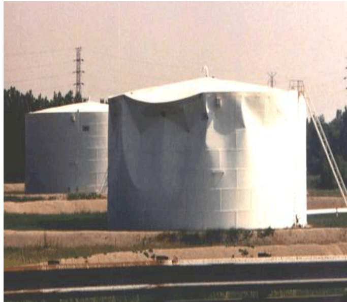
Figura 7.8 Tanque colapsado por un mal diseño de la válvula de presión / vacío, (Brant, F., 2006).
