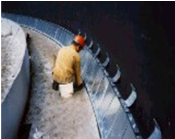
Figura 7.9 Sellos de techo en tanques flotantes, (Brant, F., 2006).
