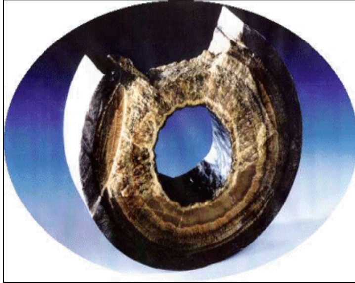
Figura 7.4 Incrustación de \text{CaCO}_3 en una tubería (PEP, 2008).
