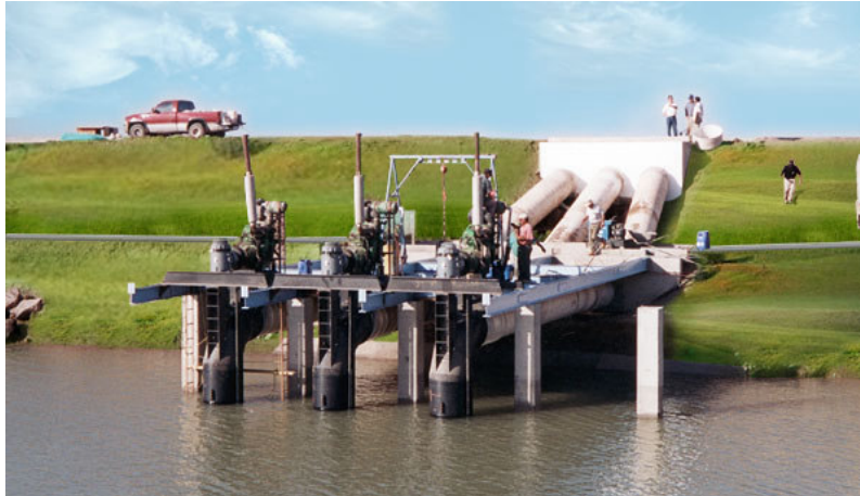
Foto 3.2. Estructura de soporte para las bombas.
