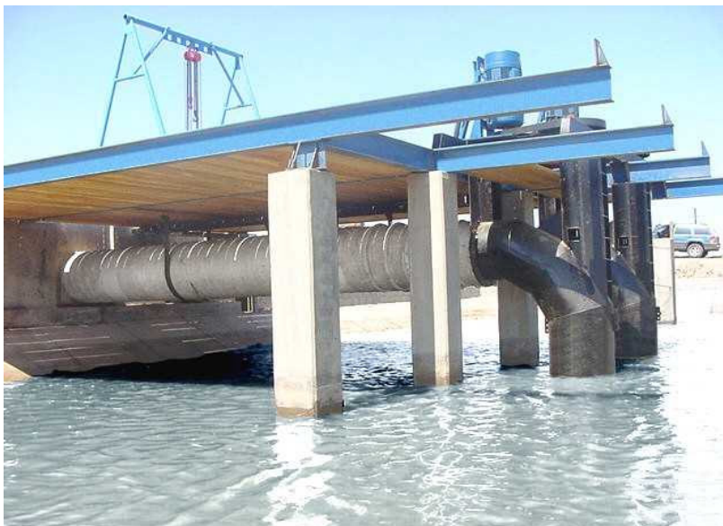
Foto 3.3. Tubería del cárcamo hacia el canal de alimentación.
