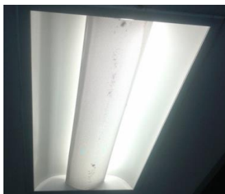
Figura 4.1- Luminarios instalados actualmente en oficinas.
