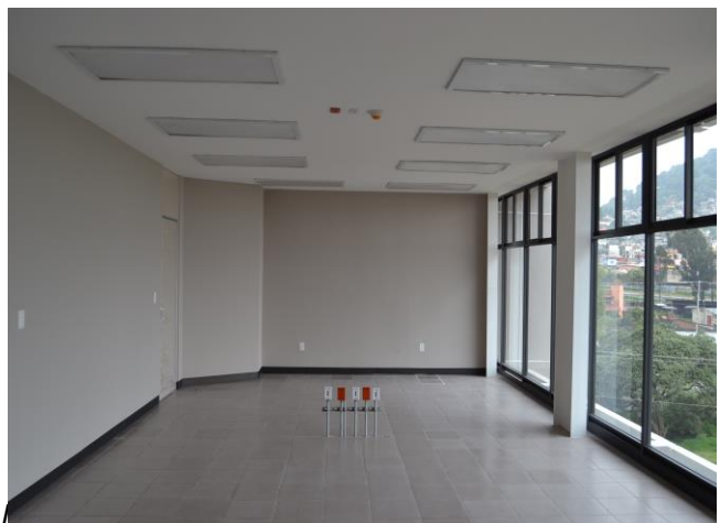
Figura III.73 Instalaciones eléctricas en zona de oficinas
