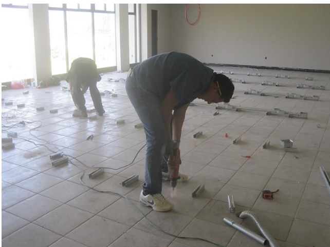
Figura III.38 Instalaciones eléctricas en laboratorio de cómputo
