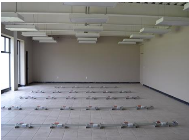
Figura III.72 Instalaciones eléctricas en laboratorio de cómputo
