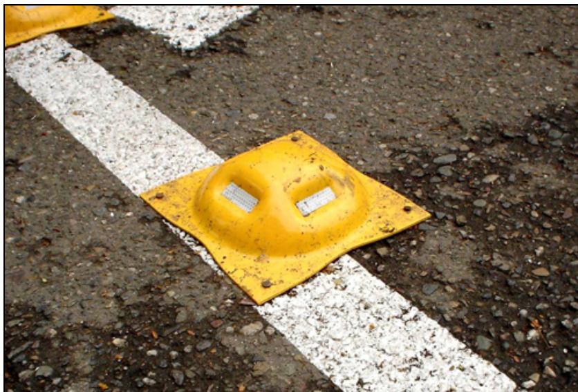
Imagen 6.1 Boya metálica utilizada para separación de flujos vehiculares
