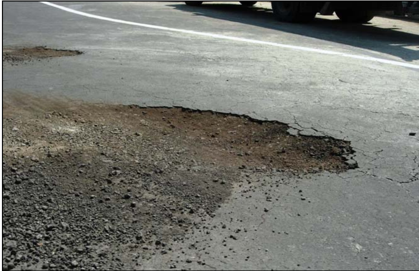
Imagen 6.6 Condiciones del pavimento en el estacionamiento 4 del Estadio Olímpico, febrero 2007
