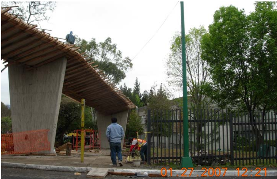
Imagen 4.3 Construcción del primer puente elevado peatonal dentro de las instalaciones de CU, éste fue inaugurado en marzo 2007
