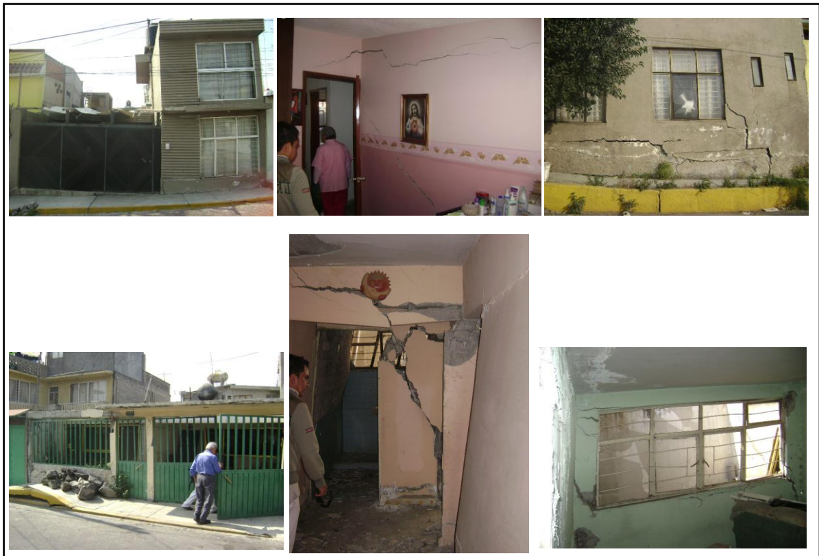
Figura. 5.30.- Imágenes de los daños causados a las estructuras de dos viviendas ocasionadas por el fracturamiento y hundimiento del suelo, en la colonia El Edén, de la Delegación Iztapalapa (Marzo 2009).
