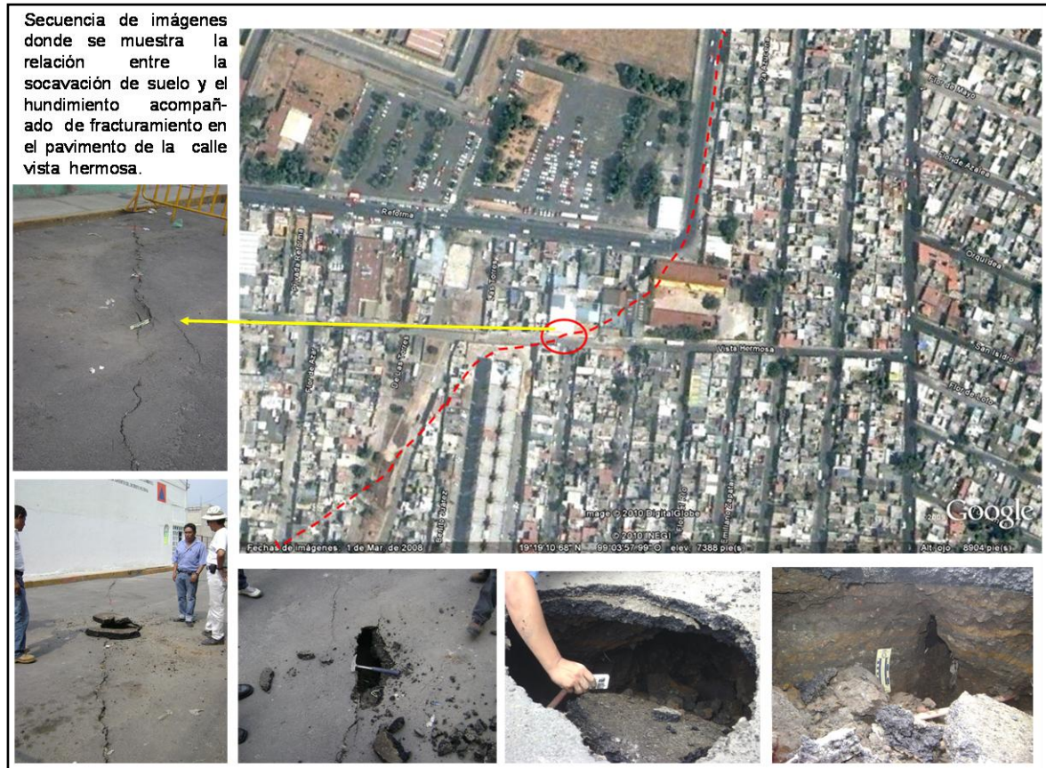
Figura 5.66.- Traza de la grieta IZT- 47 en la calle de Vista Hermosa (Marzo, 2009).
