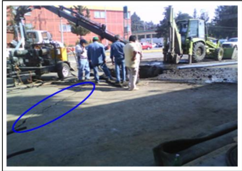
Figura 5.80.- imágenes del hundimiento provocado por la ruptura de la tubería colocada en carril dirección poniente del Eje 10 Sur, esquina calle Santa Catarina, en las elipses de las fotos se observa el trazo la grieta de tensión formada en la carpeta asfáltica (2009).
