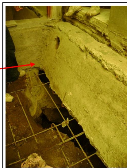
Figura 5.71.- Socavación bajo cimentación de vivienda (Julio 2009).
