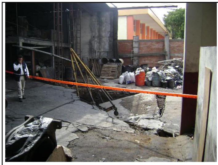
Figura 5.69.- Afectaciones en taller industrial, calle Vista Hermosa (Julio 2009).
