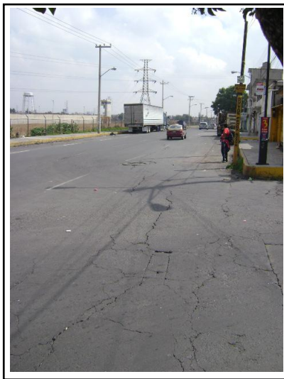
Figura 5.68.- Trazo de grieta en Av. Reforma (Enero 2010).
