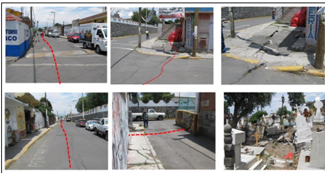
Figura 5.85.- Imágenes de la traza de agrietamiento y hundimiento sobre la calle Plutarco Elías Calles y cercana a la barda perimetral del iglesia y el panteón del Pueblo de San Andrés Mixquic (Marzo, 2010).
