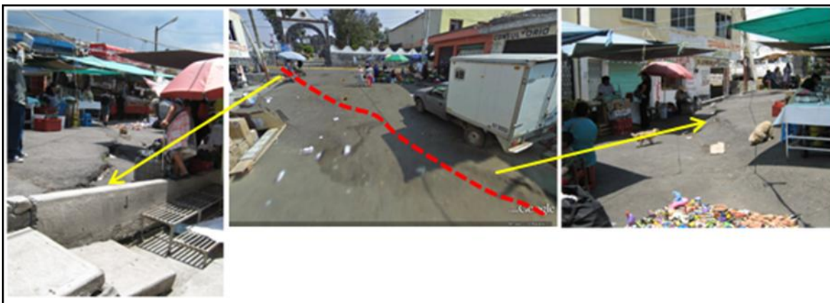
Figura 5.84.- Imágenes de la calle Medellín, la central es del 2009, comparada con imágenes de los extremos que son recientes (Junio 2010), se distingue el incremento del hundimiento y fracturamiento (Junio, 2010).
