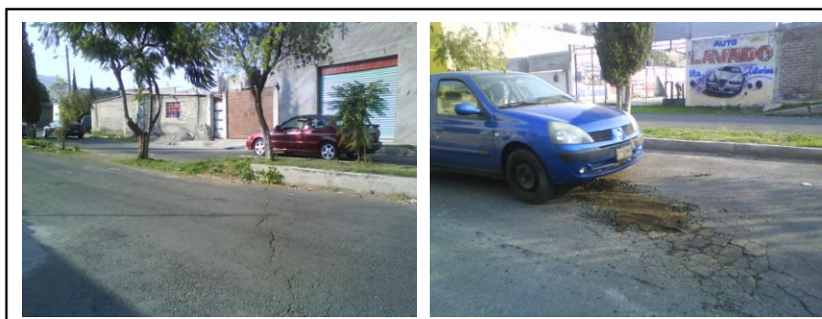
Figura 5.82.- Imágenes de la traza del agrietamiento de suelo, en la calle Luciano Navarrete esquina Antonio Centeno (2009).
