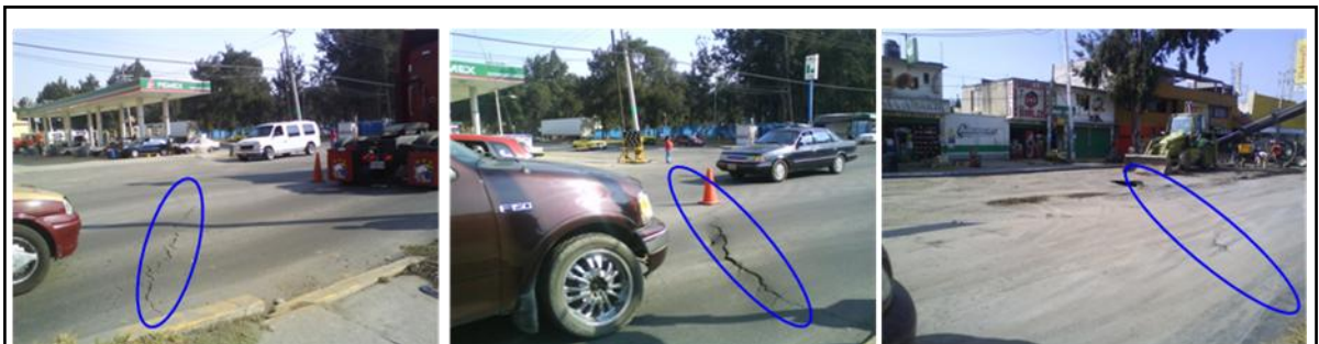
Figura 5.81.- Imágenes de la traza del agrietamiento de suelo asociado al hundimiento que afectó la tubería de 72" de diámetro que está colocada en carril norte del Eje 10 Sur, en las elipses de las fotos se observa la grieta de tensión formada en la carpeta asfáltica (2009).
