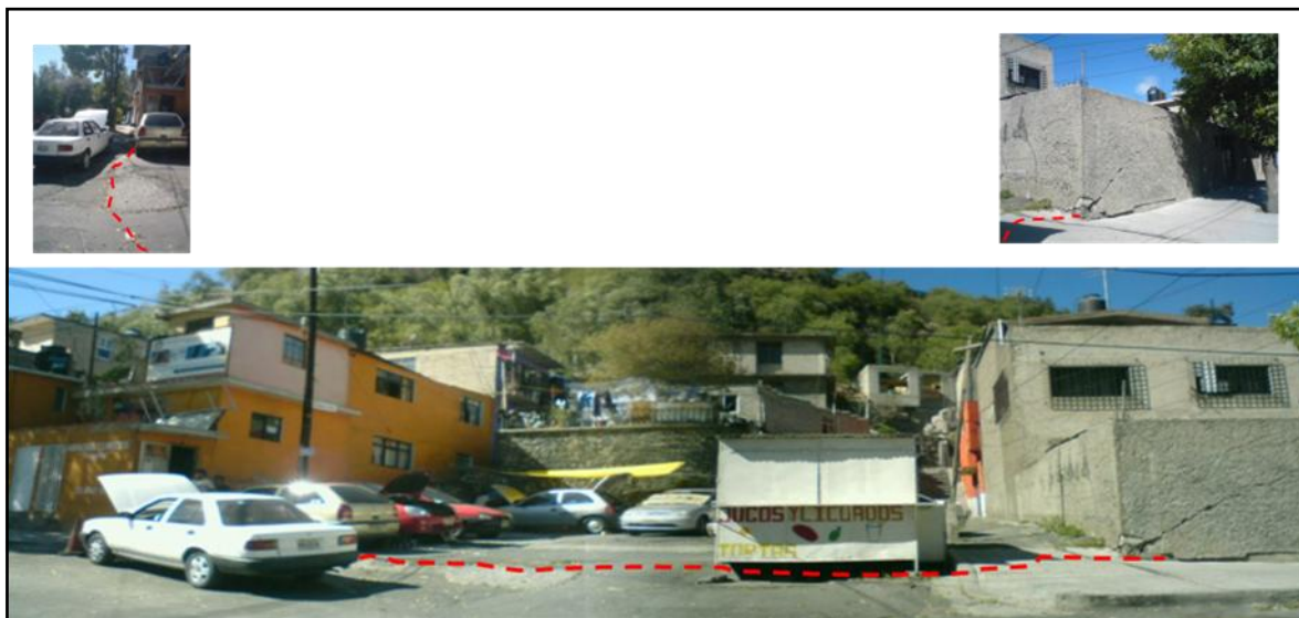
Figura 5.57.- Vista panorámica del fracturamiento con dirección NW5E en la calle Sinaloa afectando a los predios Morelos No. 76 y 58-b (2010).
