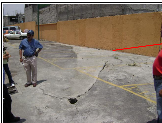
Figura 5.70.- Afectaciones unidad habitacional Benito Juárez (Julio 2009).
