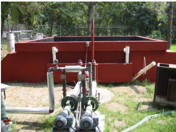
Figura 4-3. Digestor anaerobio. Vista frontal.
