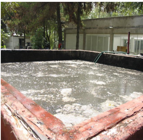
Figura 5-20. Apariencia de espejo de agua del digester UASB antes de comenzar la alimentación diaria
