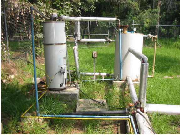
Figura 4-7. Sistema de calentamiento.
