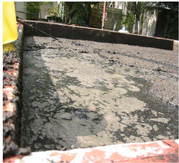
Figura 4-10. Espejo de agua del digestor después de que se retiró la nata en la misma área de la figura anterior.
