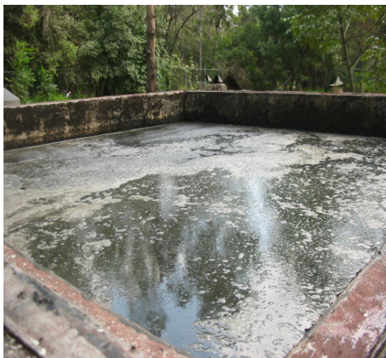
Figura 4-13. Digestor UASB sin la cubierta aislante
