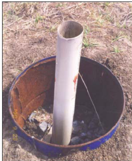
Figura 4.4b Vista final del tubo para incineración de biogás
