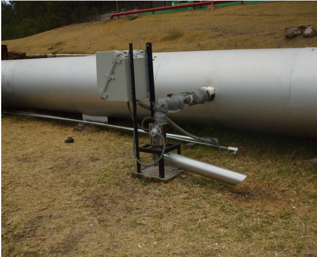
Figura 4.11 Calorímetro instalado en sitio
