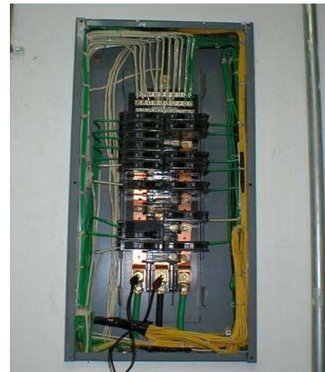
Figura 3.11 Cables sueltos dentro del tablero
