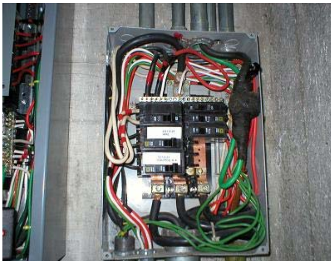
Figura 3.10 Tablero con empalme grueso
