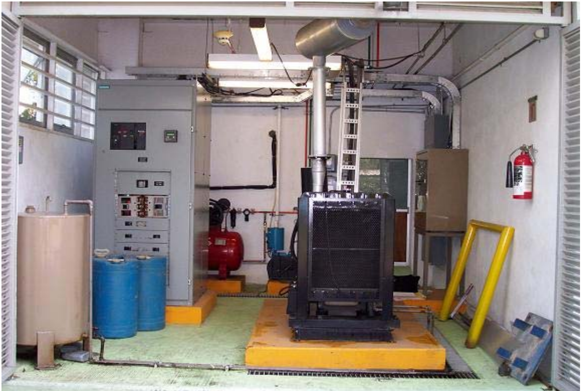
Figura 2.4 Cuarto de máquinas en el edificio anexo. Se puede observar a la izquierda el tablero general SIEMMENS, al frente la planta de emergencia de 60 kW, al fondo a la derecha el tablero de transferencia IGSA y detrás de este se encuentra el tablero 2E.
