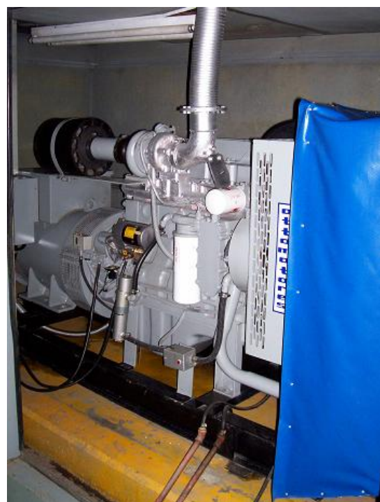
Figura 5.15. Planta de emergencia de 150 kW.
