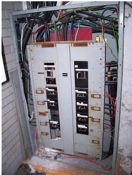
Figura 3.6 Tablero sin tapa del edificio principal.
