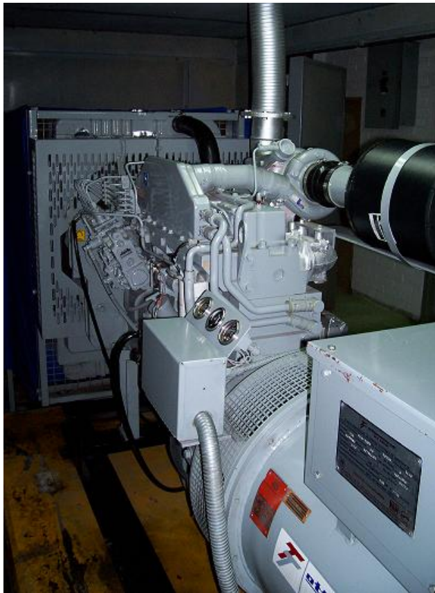
Figura 2.12 Vista del generador de la planta de emergencia de 150 kW.
