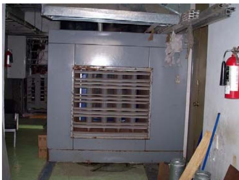
Figura 5.1 Cuarto de máquinas del edificio principal.
