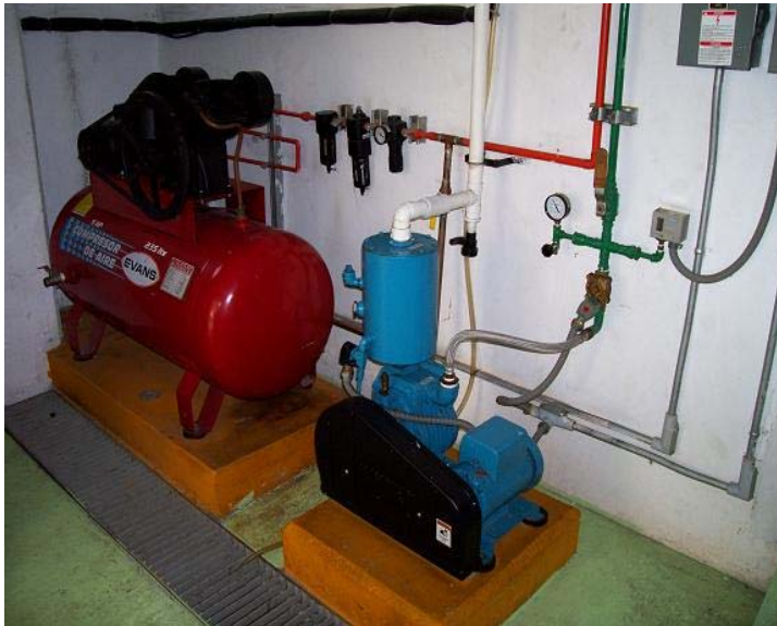
Figura 2.9 Sistema hidroneumático del edificio anexo
