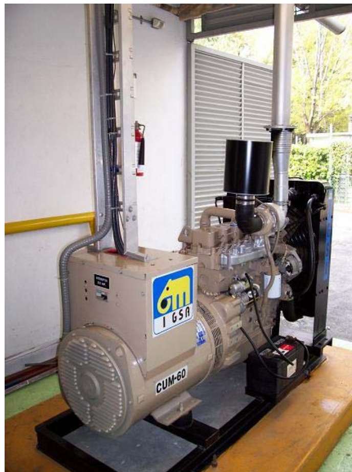
Figura 2.14 Vista general de la planta de emergencia de 60 kW.
