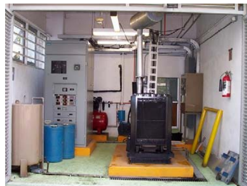
Figura 5.2 Cuarto de máquinas del anexo.
