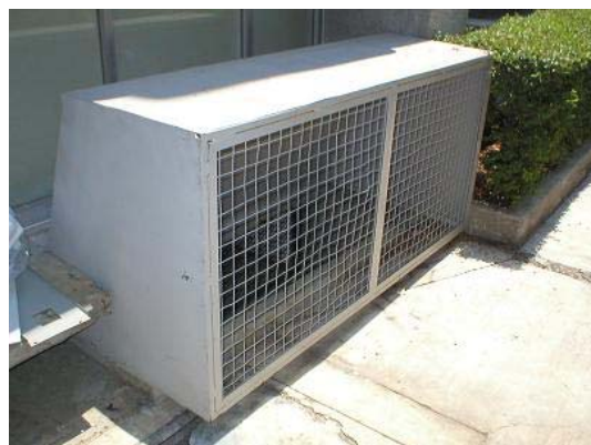
Figura 5.9 Tolva de captación de aire frío
