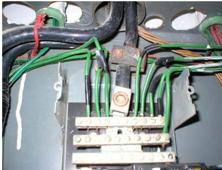
Figura 3.7 Alimentador del neutro con empalme mal hecho.
