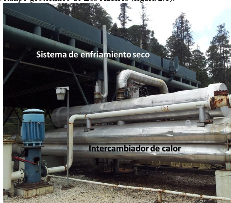
Figura 2.1.- Planta de ciclo binaria instalada en el campo geotérmico de Los Azufres México
