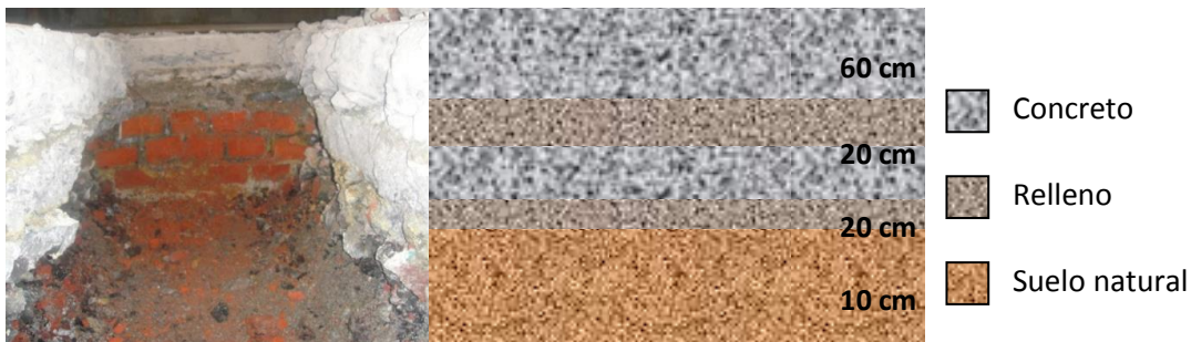
Figura 3.1. Capas del concreto armado hasta el suelo natural y esquema de las capas con sus respectivos espesores.
