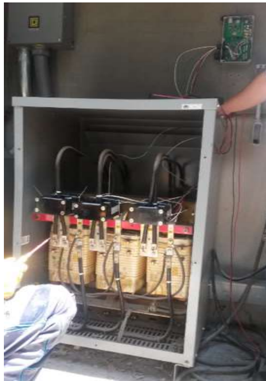
Figura 4.2 Medidor de Consumo EA instalado en el primer piso de edificio 12 del Instituto de Ingeniería de la UNAM
