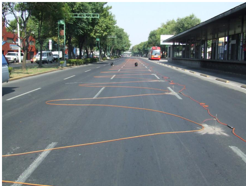
Fotografía 1. Conexión de cable multipolar a electrodos en TRE-Línea 1.
