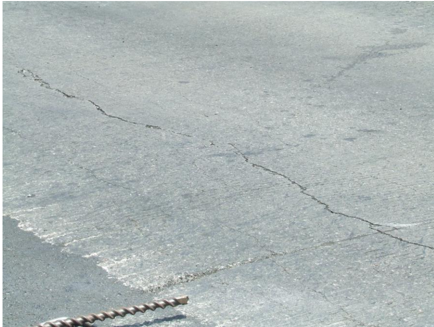
Fotografía 6. Fracturamiento de concreto hidráulico, debido a la subsidencia.
