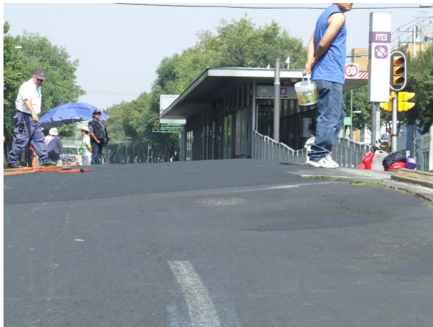
Fotografía 8. Bordo que obstruye la vialidad.
