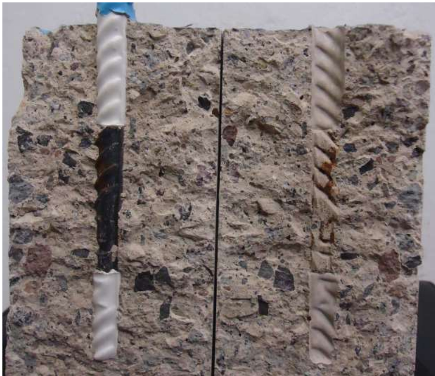
Figura 3.38.- Detalle concreto con agregado reciclado carbonatado.
