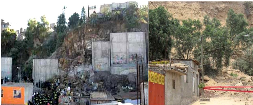
Figura 2.21 Desgajamientos en el Cerro de la Estrella, Del. Iztapalapa.
