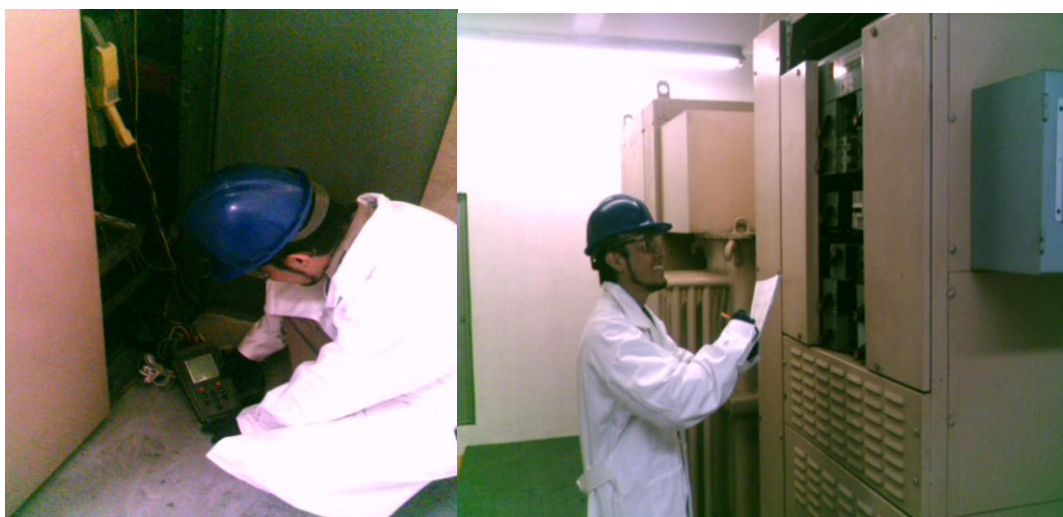
Figura 2.14 Instalación de equipo de medición.
