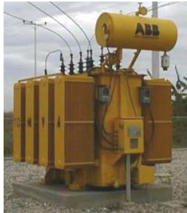
Figura 3.7. Transformador de distribución sumergido en aceite tipo intemperie.
