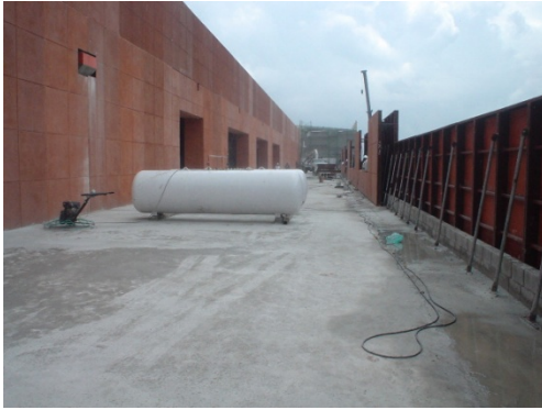
FIGURA 53. TANQUE DE GAS (SALCHICHA)
