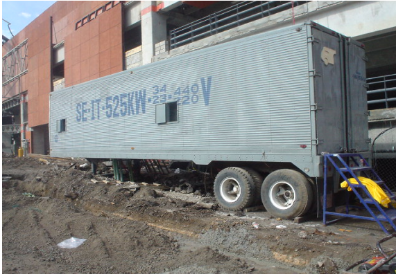
FIGURA 39. SUBESTACIÓN ELÉCTRICA PROVISIONAL
