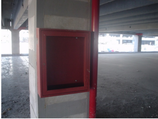
FIGURA 100. GABINETE CONTRA INCENDIO
