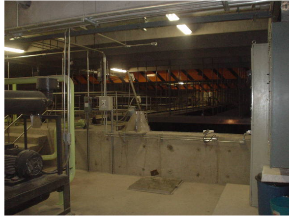
FIGURA 48. VISTA GENERAL DE LA PLANTA DE TRATAMIENTO
