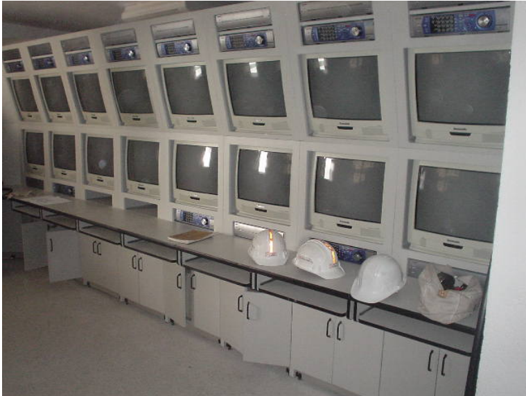
FIGURA 113. CIRCUITO CERRADO DE TELEVISIÓN PANEL DE CONTROL
