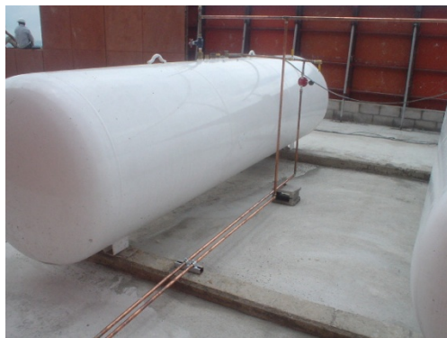
FIGURA 111. UN TANQUE DE GAS
