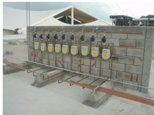
FIGURA 112. MEDIDORES DE GAS
