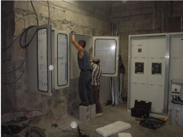
FIGURA 92. TABLEROS DE DISTRIBUCIÓN
