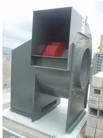
FIGURA 103. EQUIPO DE EXTRACCIÓN DE AIRE
