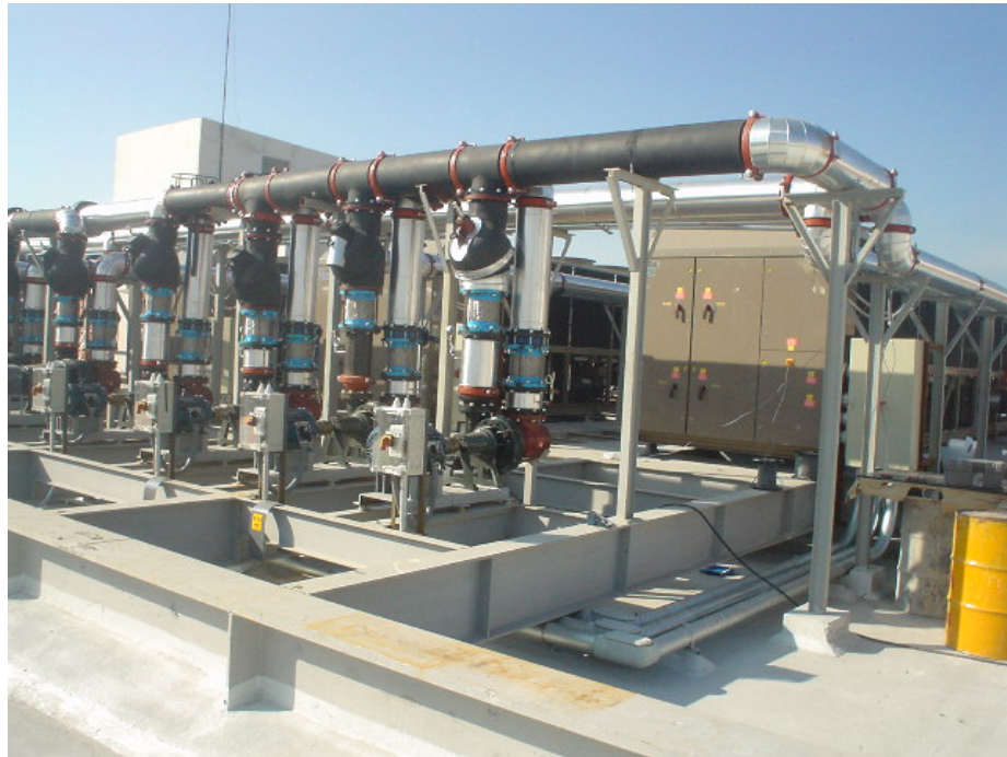
FIGURA 52. ENFRIADORES (CHILLERS) CON SU ESTACIÓN DE BOMBEO
