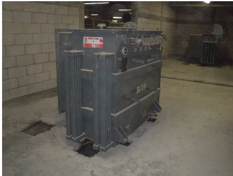
FIGURA 40. TRANSFORMADOR DE 500 KVA
