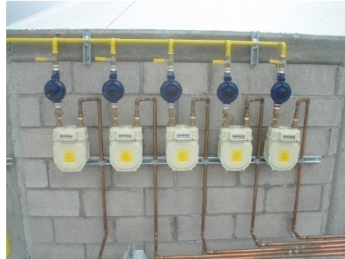
FIGURA 54. MEDIDORES DE GAS
