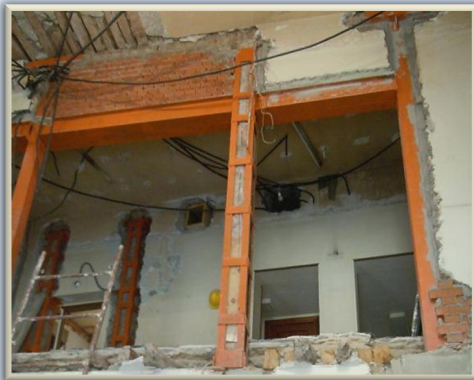
Fig. 2.1.2.14 Edificio antiguo de mampostería apuntalado con perfiles metálicos que fueron aprovechados para incorporarlos a la estructura, tanto en sustitución de columnas completas, como en reforzamiento de otras mediante la técnica de encamisado
