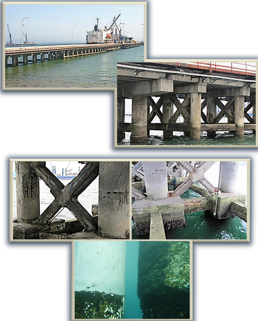
Fig.3.3.1. Rehabilitación del muelle No.1 del "Puerto Lirquen" de Chile, destinado a embarcaciones de gran calado. Arriba, vista longitudinal y acercamiento de los componentes estructurales del muelle, los cuales presentan severas afectaciones. Abajo, degradación del concreto por el fuerte intemperismo del ambiente marino
