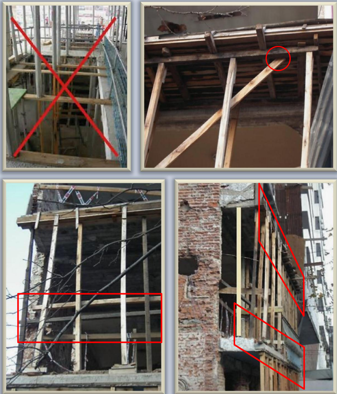
Fig. 2.1.2.10 Formas incorrectas de apuntalar. Arriba a la izquierda, se infringe el primer principio básico de todo apuntalamiento: estar firmemente apoyado. Arriba a la derecha, el arriostramiento no remata en el nodo. Abajo a la izquierda, el aparente arriostramiento horizontal no es equidistante, y el acañamiento de los puntales es defectuoso. Abajo a la derecha, el apuntalamiento de un balcón debe efectuarse al centro para que la losa de éste continúe trabajando en voladizo
