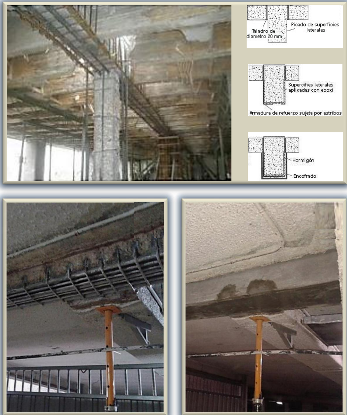
Fig. 2.4.2.4. Encamisados de concreto reforzado. Arriba, con refuerzo tanto longitudinal (flexión), como transversal (cortante), además, encamisado de columna y esquema secuencial. Abajo, longitudinal (sólo para flexión)
