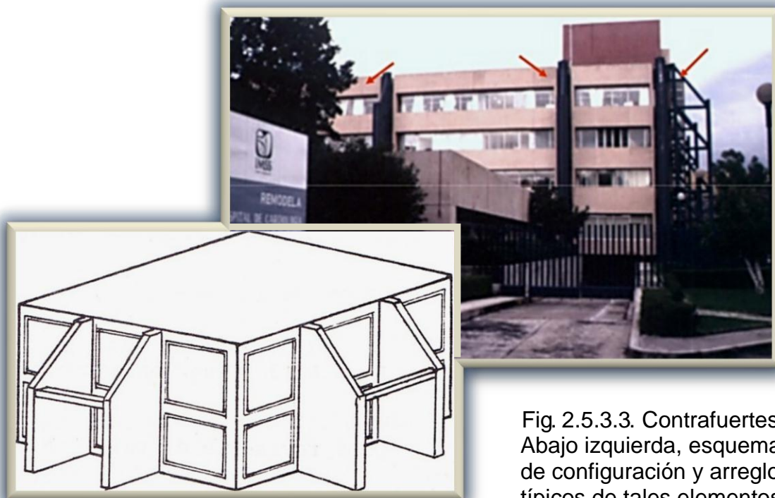
Fig. 2.5.3.3. Contrafuertes. Abajo izquierda, esquema de configuración y arreglo típicos de tales elementos. Arriba derecha, imagen de la utilización de contrafuertes de acero en la rehabilitación de un centro hospitalario (Instituto de Cardiología del IMSS, Cd. de México).
