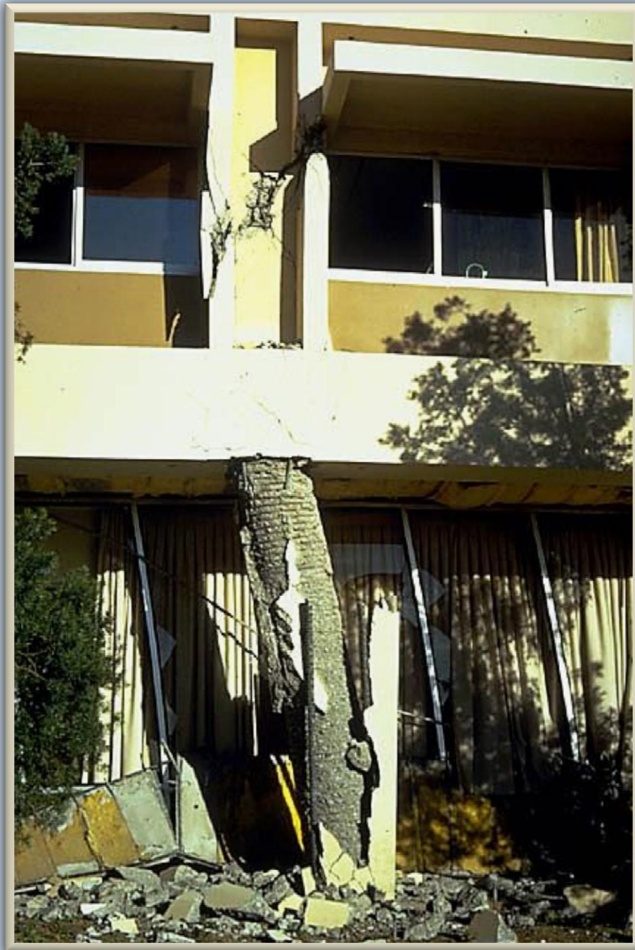
Fig. 1.2.1.a.2- 4) Combinación de Fallas por transición inadecuada en columnas coalineadas de entrespisos contiguos. La columna superior de sección rectangular, falló por cortante simple, mientras que en la inferior, circular y de menor área, se formó una articulación que amplificó el efecto de flexocompresión
