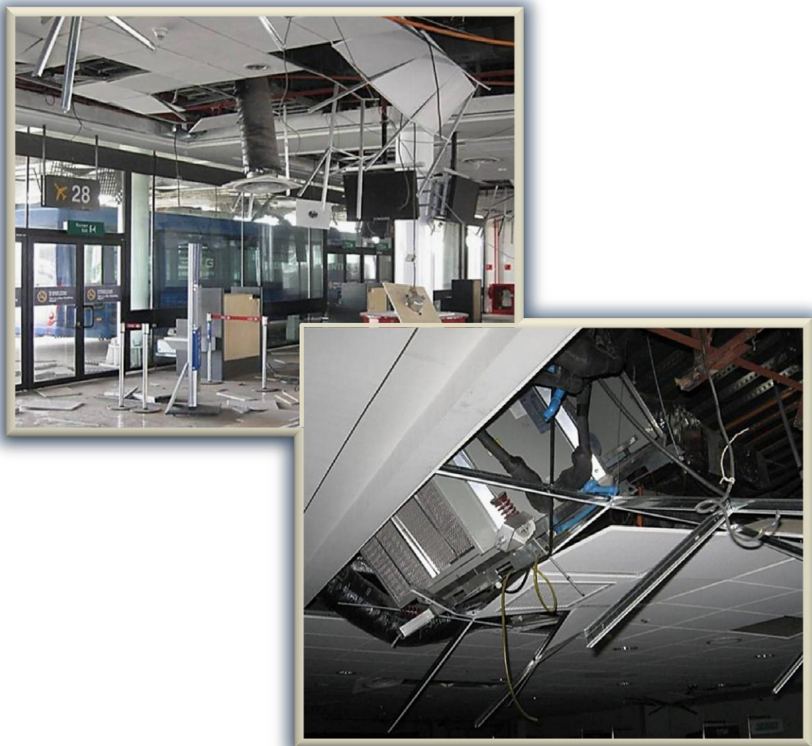
Fig. 2.6.1. Ejemplos de daños típicos en elementos no estructurales. Arriba, caída de falso plafón en una Terminal aérea de Chile. Abajo, desprendimiento de un equipo de aire acondicionado en el mismo edificio Terminal
