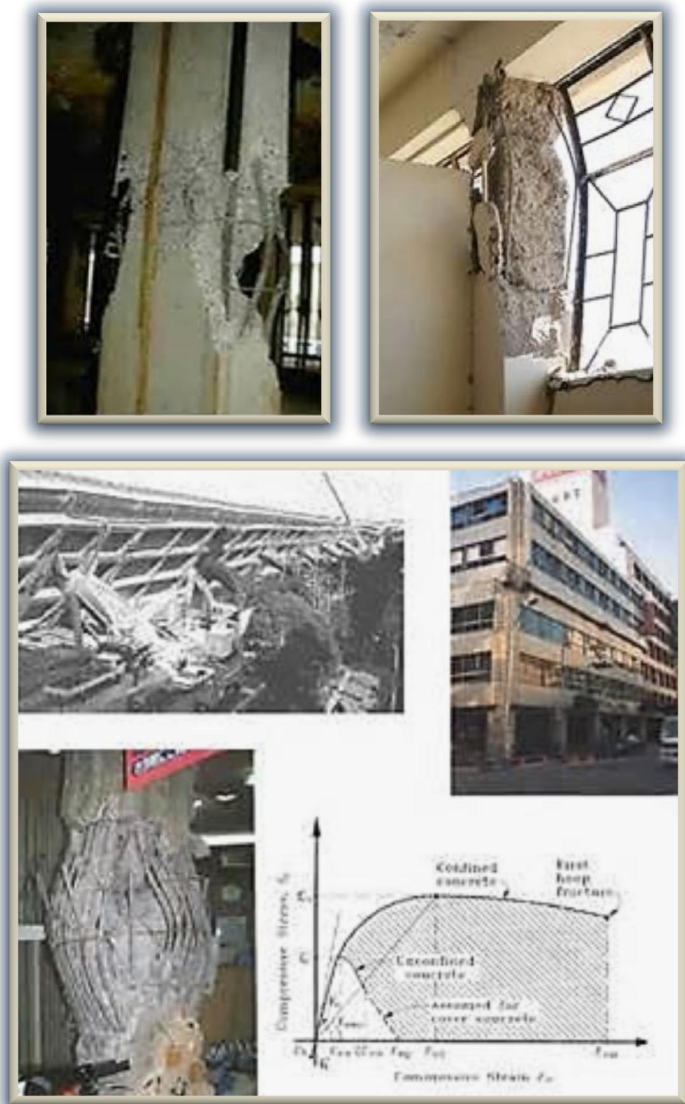
Fig. 1.2.1.a.2-3) Más fallas por flexocompresión. Nuevamente nótese el desprendimiento de concreto y pandeo de barras
