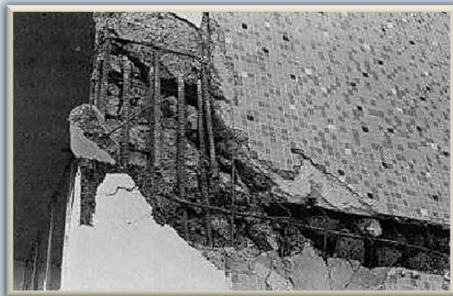
Fig. 1.2.1.e.2-2.2) Otro ejemplo de falla en forma de agrietamiento horizontal extenso en la junta de unión con el sistema de piso. Asimismo la falta de estribos en el extremo inferior causó falla frágil por cortante en esa parte
