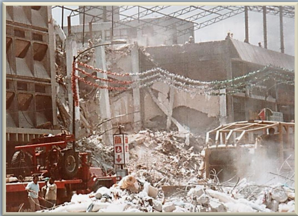
Fig. 1.2.1.c.2-1.2) Ejemplos reales de fallas por penetración en losas planas, que originó el colapso total de entresijos, no obstante de haber permanecido en pie y casi inalteradas varias columnas
