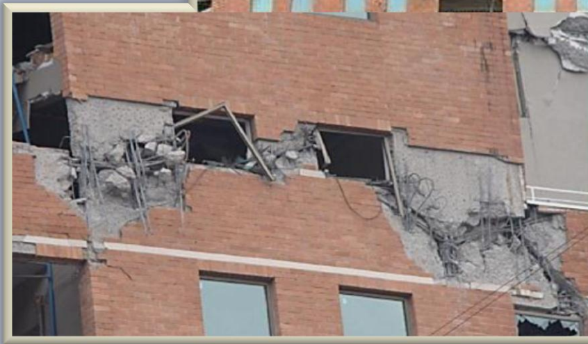
Fig. 1.2.1.e.2-1.1) Fallas por cortante en muros de concreto armado, debido a refuerzo horizontal escaso (arriba), y cambios bruscos de rigidez y forma en planta y elevación (abajo)
