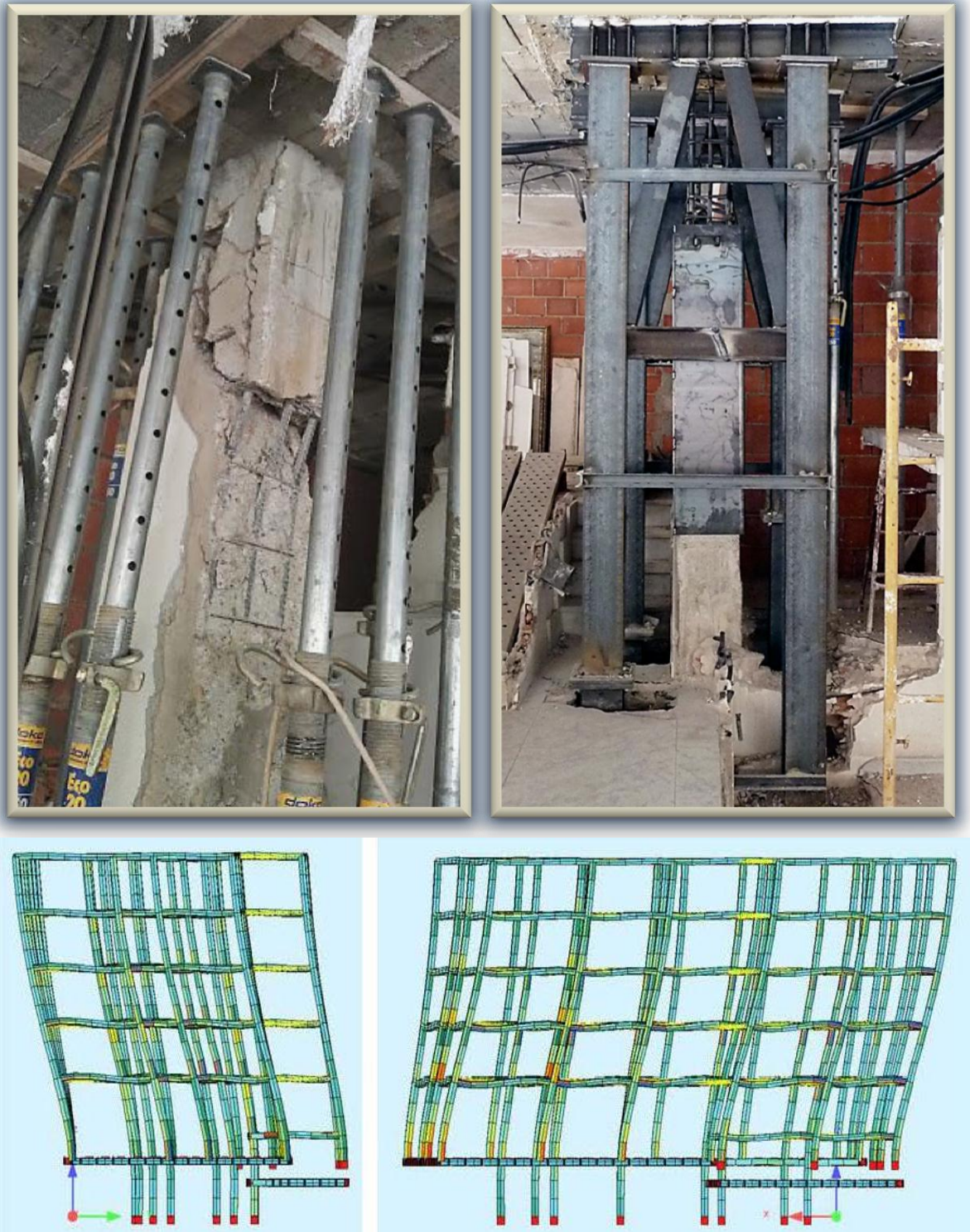
Fig. 2.1.2.13.b) Arriba a la izquierda: apuntalamiento de emergencia alrededor de columna fallada por cortante. Arriba a la derecha: misma columna en reparación, sustituyendo apuntalamiento de emergencia por provisional de perfiles de acero. Abajo: modelación de la estructura (parte del proceso de rehabilitación).
