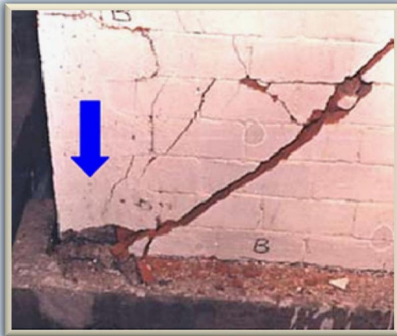
Fig. 1.2.1.f.2-1) Ejemplos de fallas típicas por cortante en mampostería. Arriba, falla debida al cambio de altura brusco del muro, acentuada por la falta de elementos de confinamiento. Abajo, no obstante de la falla a 45° del muro, el castillo se mantuvo prácticamente intacto debido a que cuenta con refuerzo transversal
