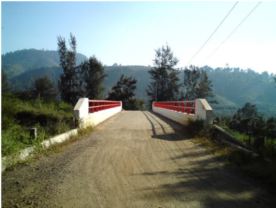
Figura 5. Fotografía de la vista general de la superficie de rodamiento.
