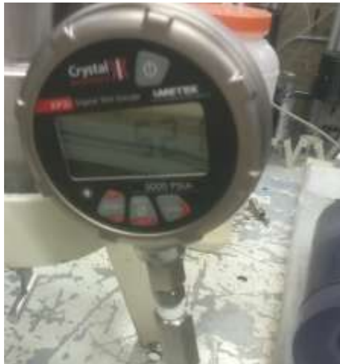
Fig. 3.5 Medidor de presión.
