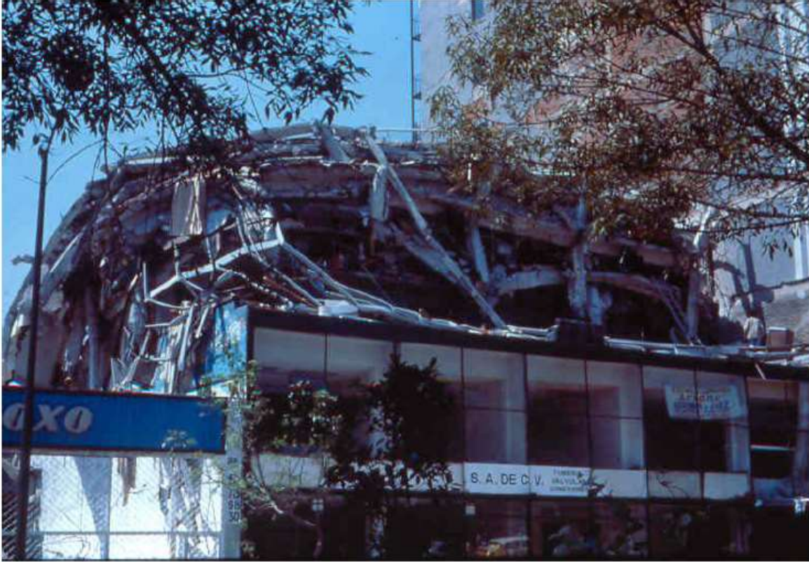
Figura 1.11 Daños estructurales por sismo en 1985.
