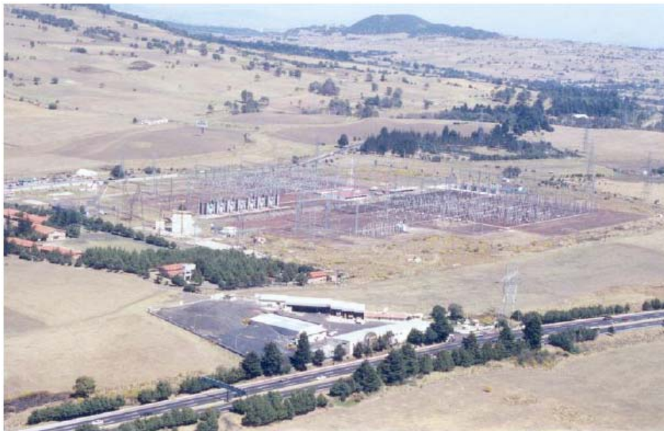
Figura 3.7. Foto panorámica de la Subestación Eléctrica Topilejo
