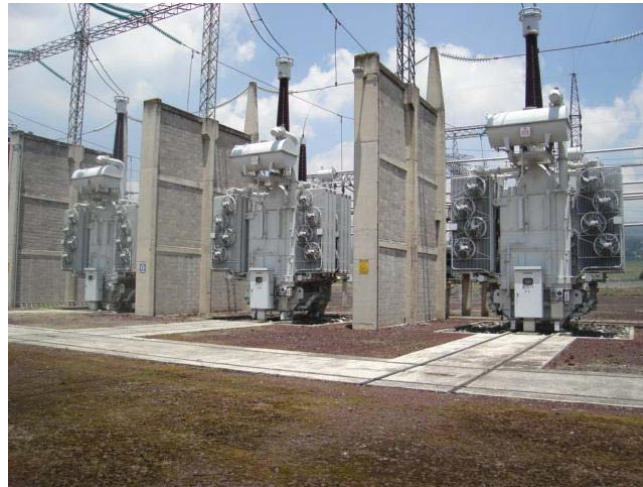
Figura 3.5. Banco de Autotransformadores S.E. Topilejo zona de 400/230 kV.
