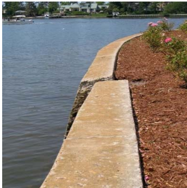
Figura 1. 12 Ejemplo de falla de un muro vertical
