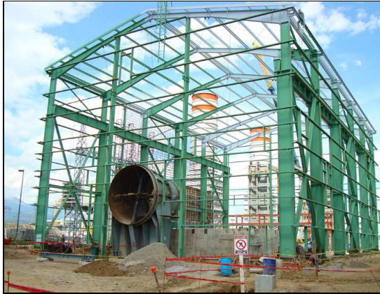
Figura 2.5. Estructura Casa de Máquinas Ciclo Combinado “San Lorenzo”
