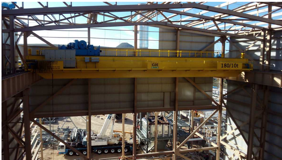
Figura 3.2. Grúa puente de 180 toneladas de capacidad de carga
