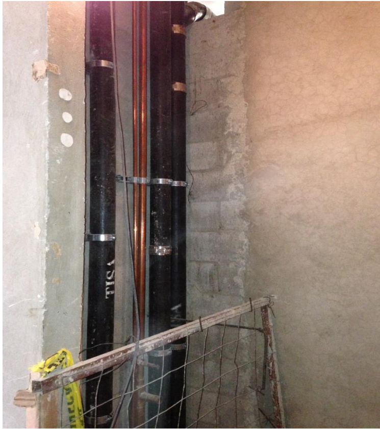
Ilustración 41. Ducto de instalaciones hidrosanitarias
