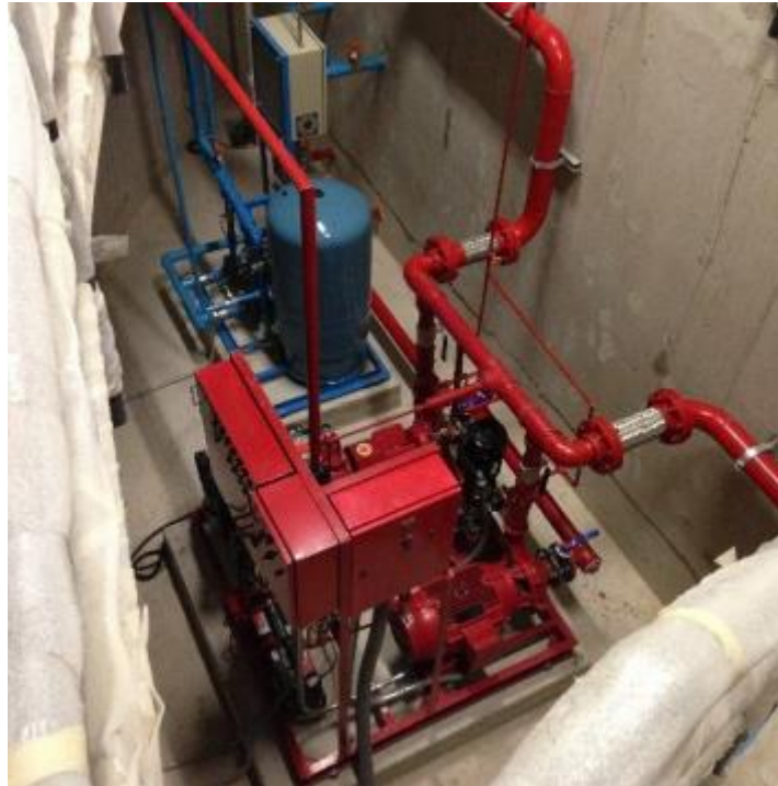
Ilustración 45. Hidroneumático y sistema de protección contra incendios
