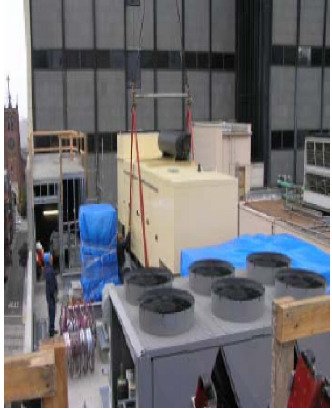
Sistemas de Ventilación, Calefacción y Aire Acondicionado
