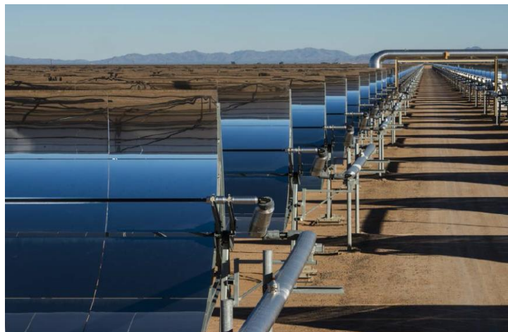
Fig. 1.8. Planta solar de Solana con una capacidad de 250 MW y 6 horas de almacenamiento por medio de aceite térmico.
