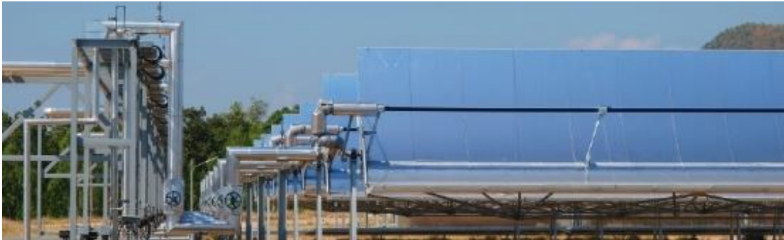
Fig. 1.11. Planta solar de 5 MW con generación directa de vapor en Tailandia.
